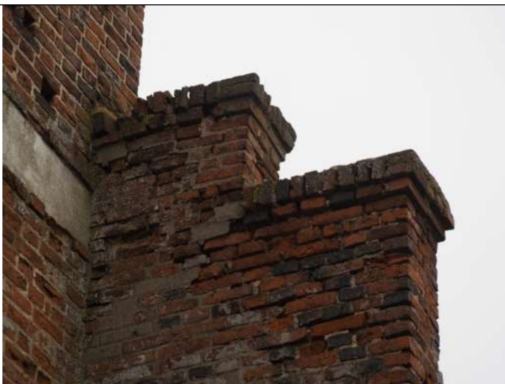
37. Galiny, kościół parafialny pw. Wniebowzięcia Najświętszej Maryi Panny; korpus, elewacja zachodnia, półszczyt południowy – brak obróbek blacharskich; rozwarstwienie konstrukcji murowej; ubytki zapraw i budulca; współczesne naprawy zaprawą cementową.
