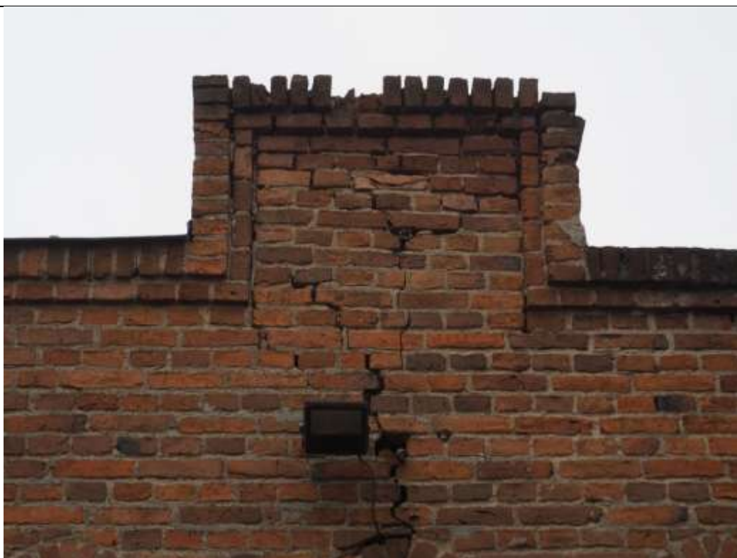
35. Galiny, kościół parafialny pw. Wniebowzięcia Najświętszej Maryi Panny; kruchta, elewacja północna, szczyt, część środkowa – ubytki obróbek blacharskich; rozwarstwienie konstrukcji murowej; ubytki zapraw i budulca w obrębie nakrywy.
