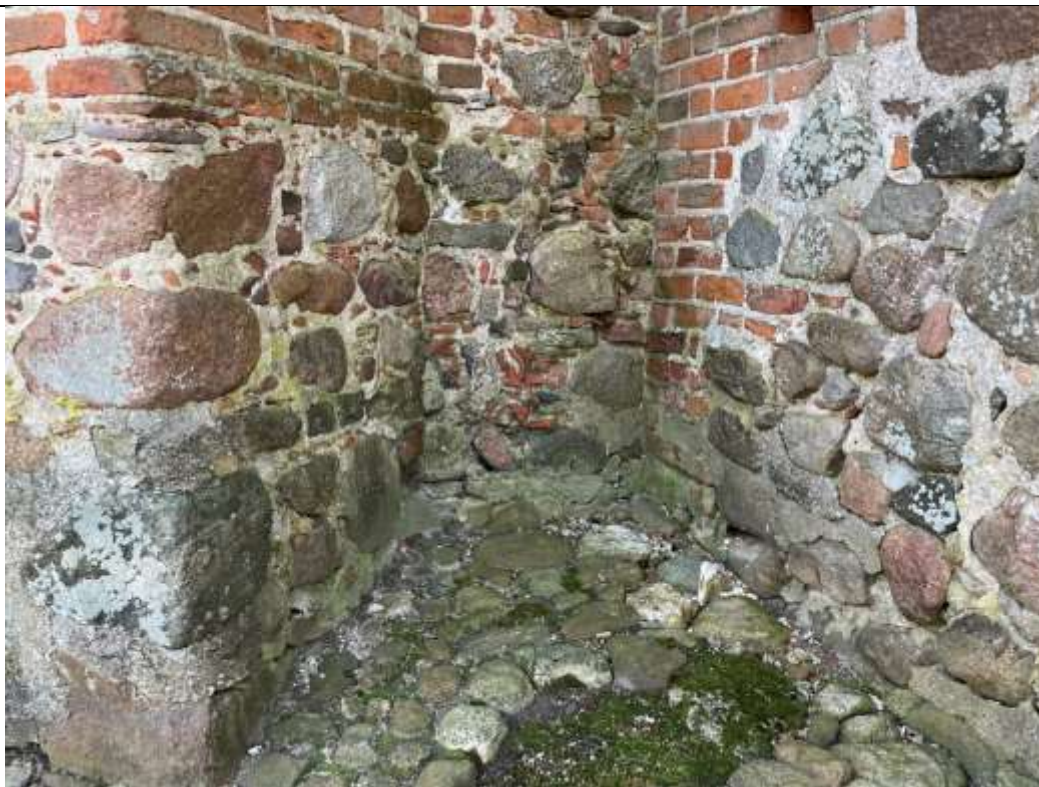
8. Galiny, kościół parafialny pw. Wniebowzięcia Najświętszej Maryi Panny; naroże elewacji zachodniej korpusu i elewacji północnej wieży, przyziemie – zawilgocenie, odspojenia i ubytki zaprawy powyżej opaski.
