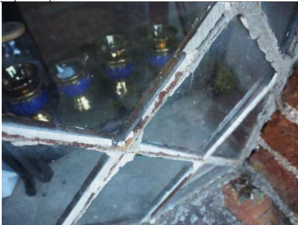
81. Galiny, kościół parafialny pw. Wniebowzięcia Najświętszej Maryi Panny; zakrystia, elewacja północna, kondygnacja I, część wschodnia; okno, strona zewnętrzna – ubytki kitu; zabrudzenia i zarysowania na powierzchni szklenia.
