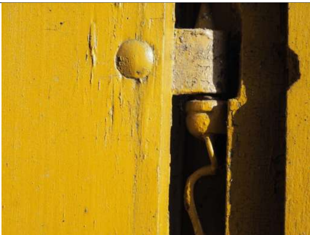
66. Galiny, kościół parafialny pw. Wniebowzięcia Najświętszej Maryi Panny; korpus, elewacja południowa; drzwi, strona wewnętrzna – współczesne przemalowania elementów konstrukcji i okuć.
