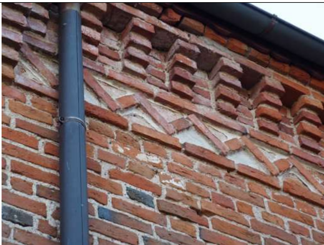
45. Galiny, kościół parafialny pw. Wniebowzięcia Najświętszej Maryi Panny; korpus, elewacja północna, skraj wschodni, zwieńczenie – odspojenia i ubytki tynku wapiennego w obrębie fryzu.
