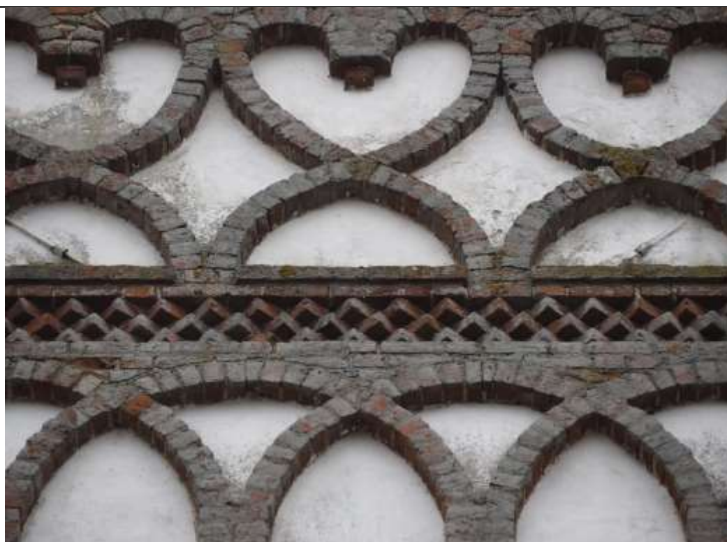
51. Galiny, kościół parafialny pw. Wniebowzięcia Najświętszej Maryi Panny; elewacja zachodnia, szczyt – współczesne nawarstwienia, odspojenia, ubytki wypraw.
