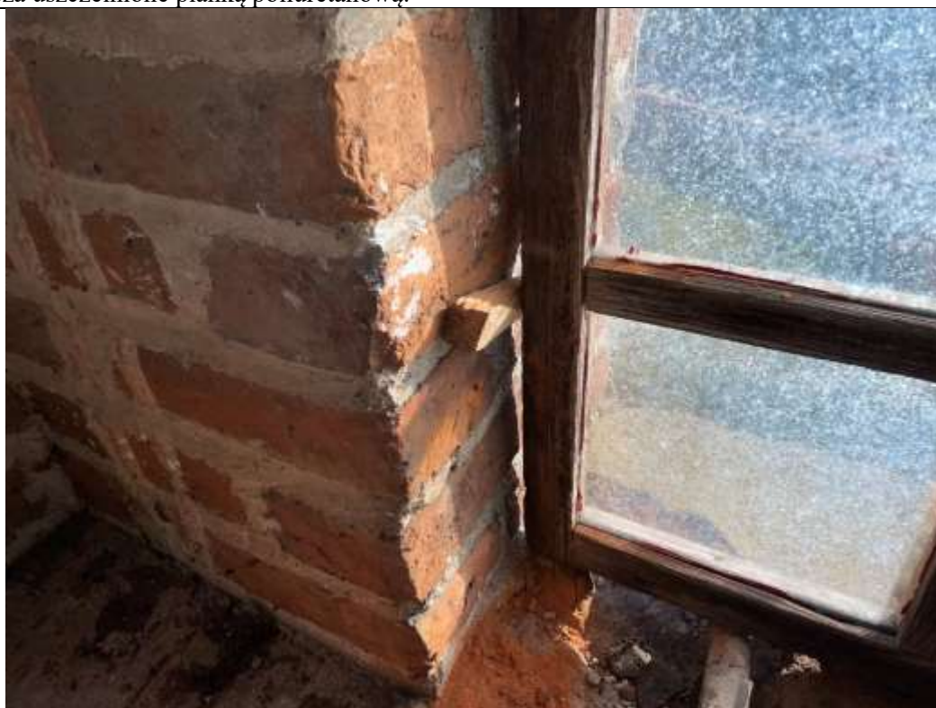
87. Galiny, kościół parafialny pw. Wniebowzięcia Najświętszej Maryi Panny; wieża, elewacja północna, kondygnacja III (IV), część środkowa; okno, strona wewnętrzna – konstrukcja współczesna; prowizoryczne mocowanie przy pomocy klinów.
