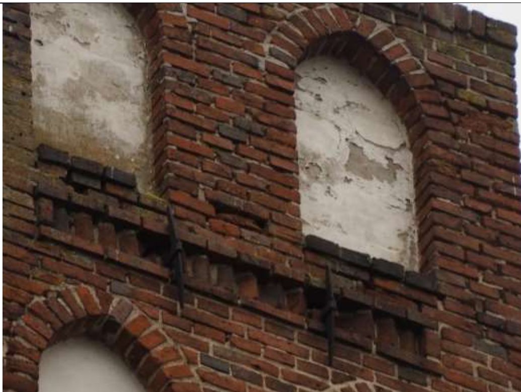
91. Galiny, kościół parafialny pw. Wniebowzięcia Najświętszej Maryi Panny; wieża, elewacja wschodnia, szczyt; zwieńczenie – silnie skorodowane przewłoczki kotew.
