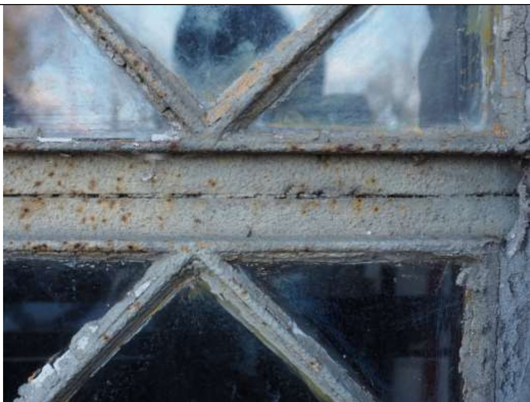
80. Galiny, kościół parafialny pw. Wniebowzięcia Najświętszej Maryi Panny; zakrystia, elewacja północna, kondygnacja I, część wschodnia; okno, strona zewnętrzna – korozja elementów metalowych; współczesne przemalowania.
