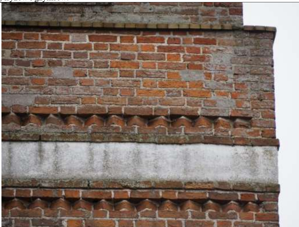
29. Galiny, kościół parafialny pw. Wniebowzięcia Najświętszej Maryi Panny; wieża, elewacja zachodnia, kondygnacja II, część południowa – skupiska porostów poniżej fryzów, gzymsów, odsadzki parapetowej.
