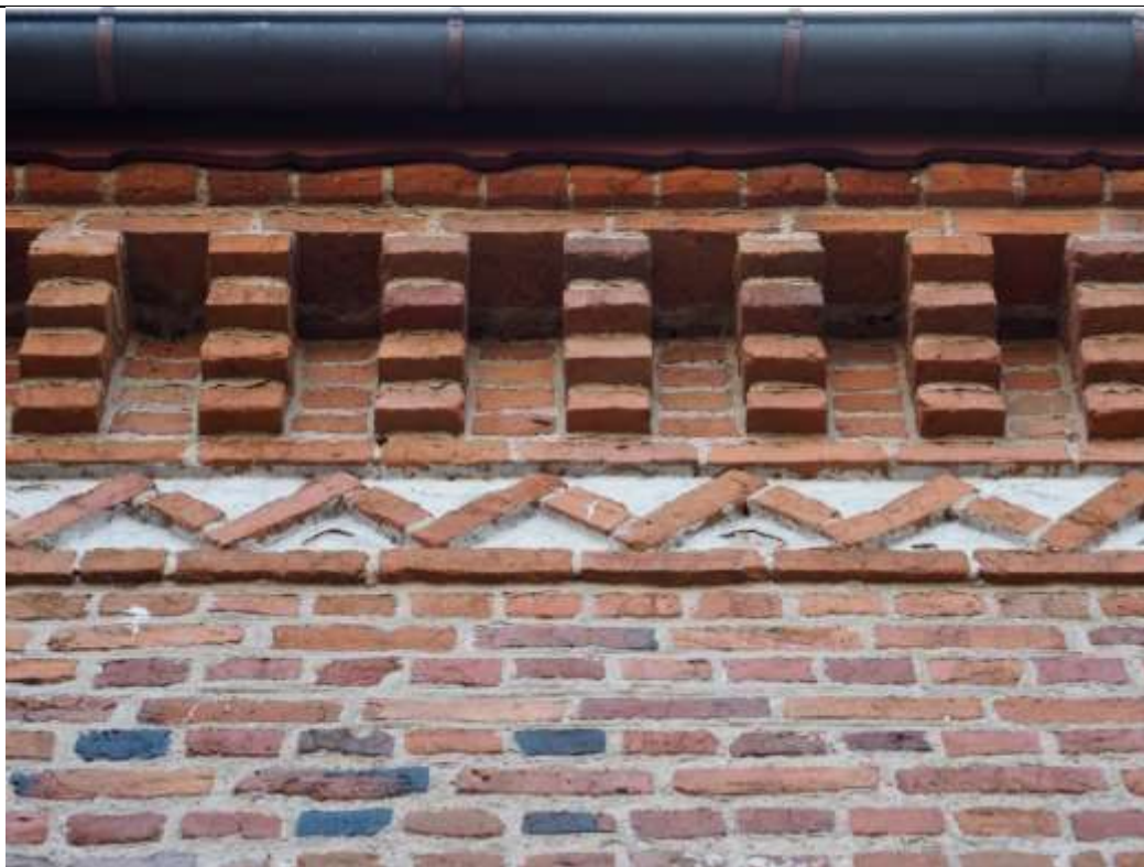
24. Galiny, kościół parafialny pw. Wniebowzięcia Najświętszej Maryi Panny; prezbiterium, elewacja północna, zwieńczenie, część zachodnia – XIX- wieczne przemurowania i spoinowania wątku ceglano-ego; spękania i drobne ubytki budulca w obrębie elementów wieńczących.
