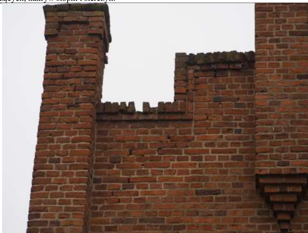
33. Galiny, kościół parafialny pw. Wniebowzięcia Najświętszej Maryi Panny; prezbiterium, elewacja wschodnia, szczyt, część południowa – odspojenia, ubytki zapraw i budulca w obrębie nakryw stopni.
