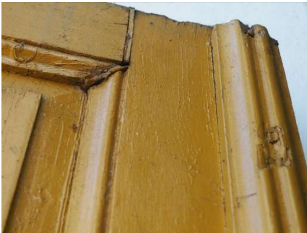
67. Galiny, kościół parafialny pw. Wniebowzięcia Najświętszej Maryi Panny; korpus, elewacja południowa; drzwi, strona wewnętrzna – uszkodzenia mechaniczne drewna na krawędziach ramiaków skrzydeł i profilach listwy przemykowej.
