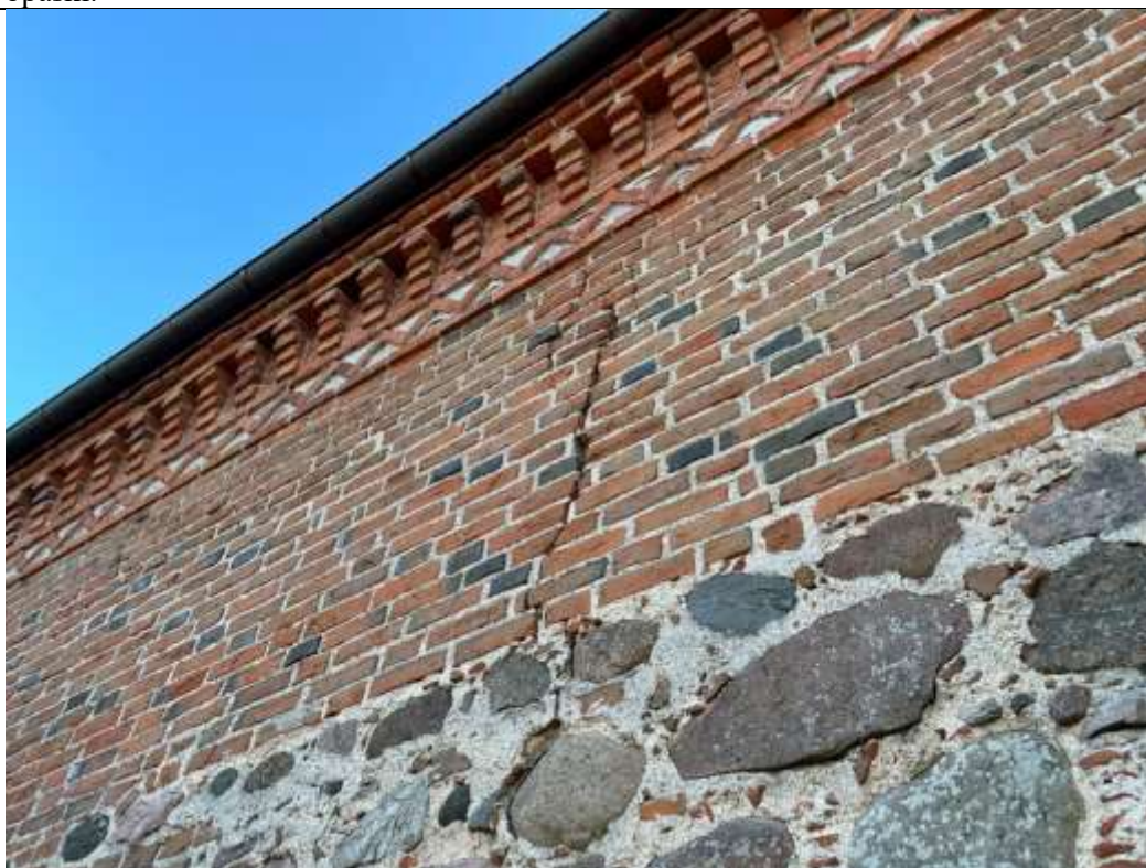
9. Galiny, kościół parafialny pw. Wniebowzięcia Najświętszej Maryi Panny; korpus, elewacja północna, powyżej przyziemia, skraj zachodni – spękanie strukturalne muru.
