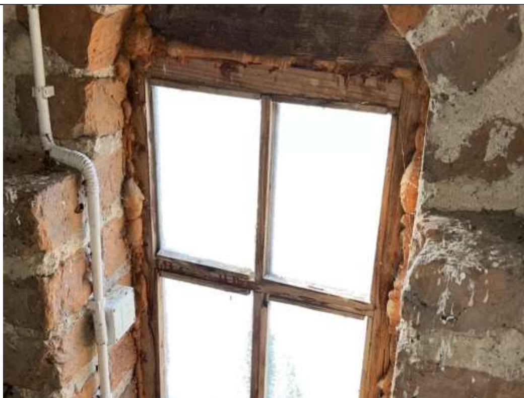
86. Galiny, kościół parafialny pw. Wniebowzięcia Najświętszej Maryi Panny; wieża, elewacja zachodnia, kondygnacja I (II), część środkowa; okno, strona wewnętrzna – konstrukcja współczesna; obrzeża uszczelnione pianką poliuretanową.
