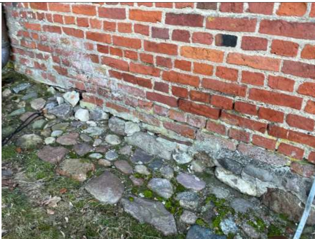
21. Galiny, kościół parafialny pw. Wniebowzięcia Najświętszej Maryi Panny; kruchta, elewacja wschodnia, przyziemie, część środkowa – ubytki zapraw w obrębie strefy cokołowej; opaska z kamienia polnego.
