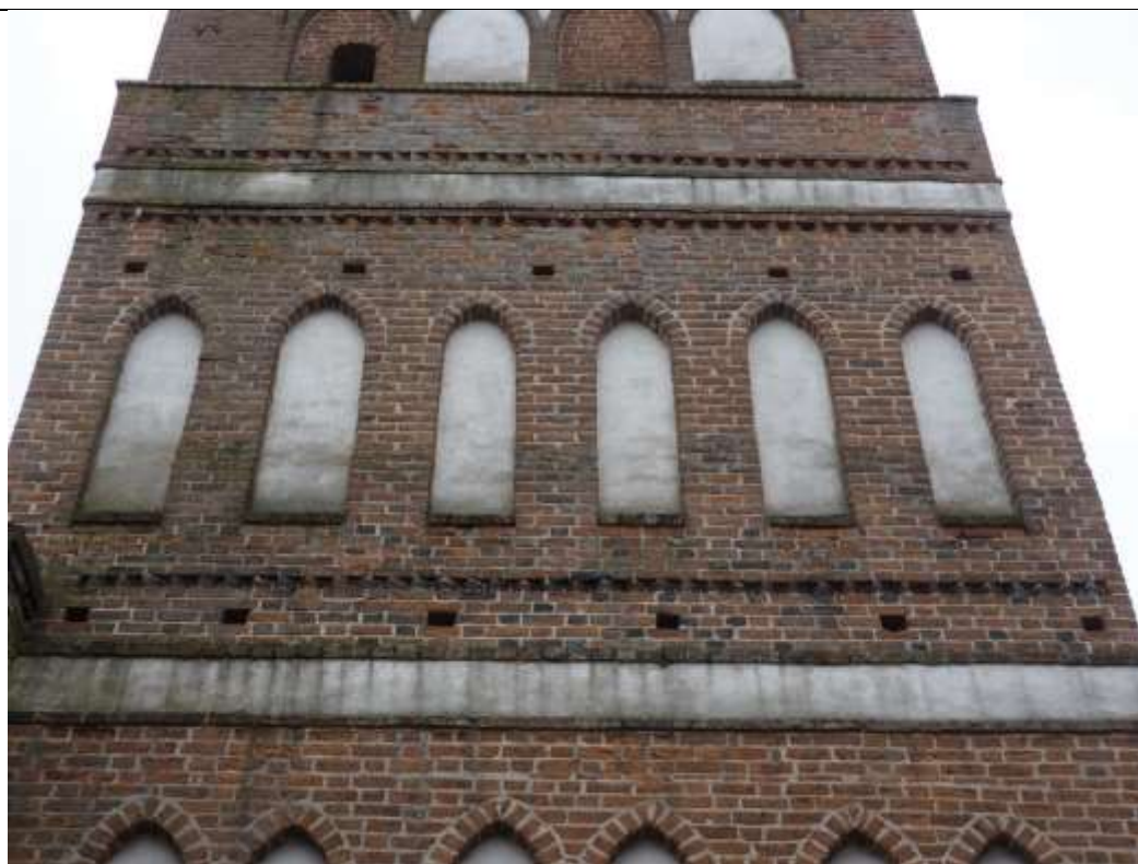
30. Galiny, kościół parafialny pw. Wniebowzięcia Najświętszej Maryi Panny; elewacja północna, kondygnacja II – zabrudzone, pokryte porostami powierzchnie wątku ceglanego i wypraw.
