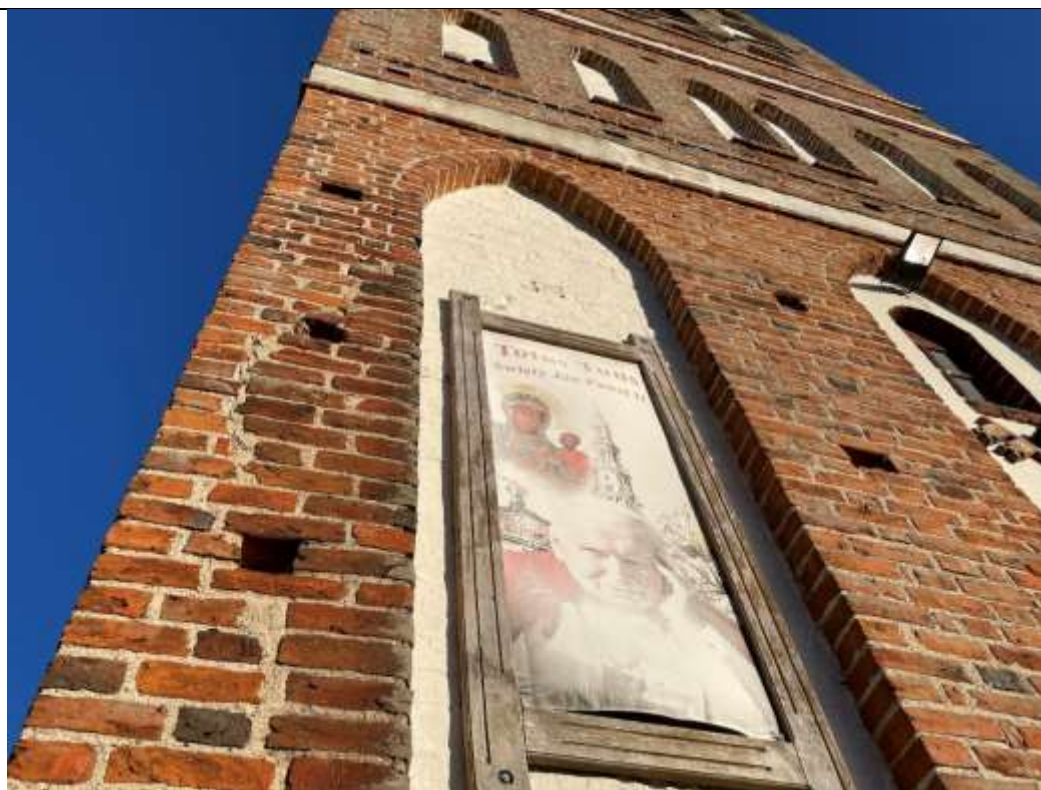
12. Galiny, kościół parafialny pw. Wniebowzięcia Najświętszej Maryi Panny; wieża, elewacja zachodnia, kondygnacja I, część północna – spękanie naroża wypełnione zaprawą wapienną podczas XIX-wiecznych prac restauratorskich.
