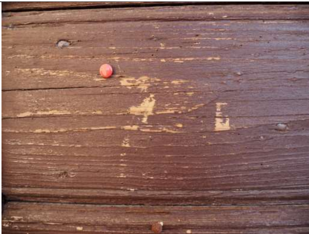
55. Galiny, kościół parafialny pw. Wniebowzięcia Najświętszej Maryi Panny; elewacja zachodnia; drzwi – spękania drewna, ubytki powłoki malarskiej na zewnętrznej stronie skrzydeł.
