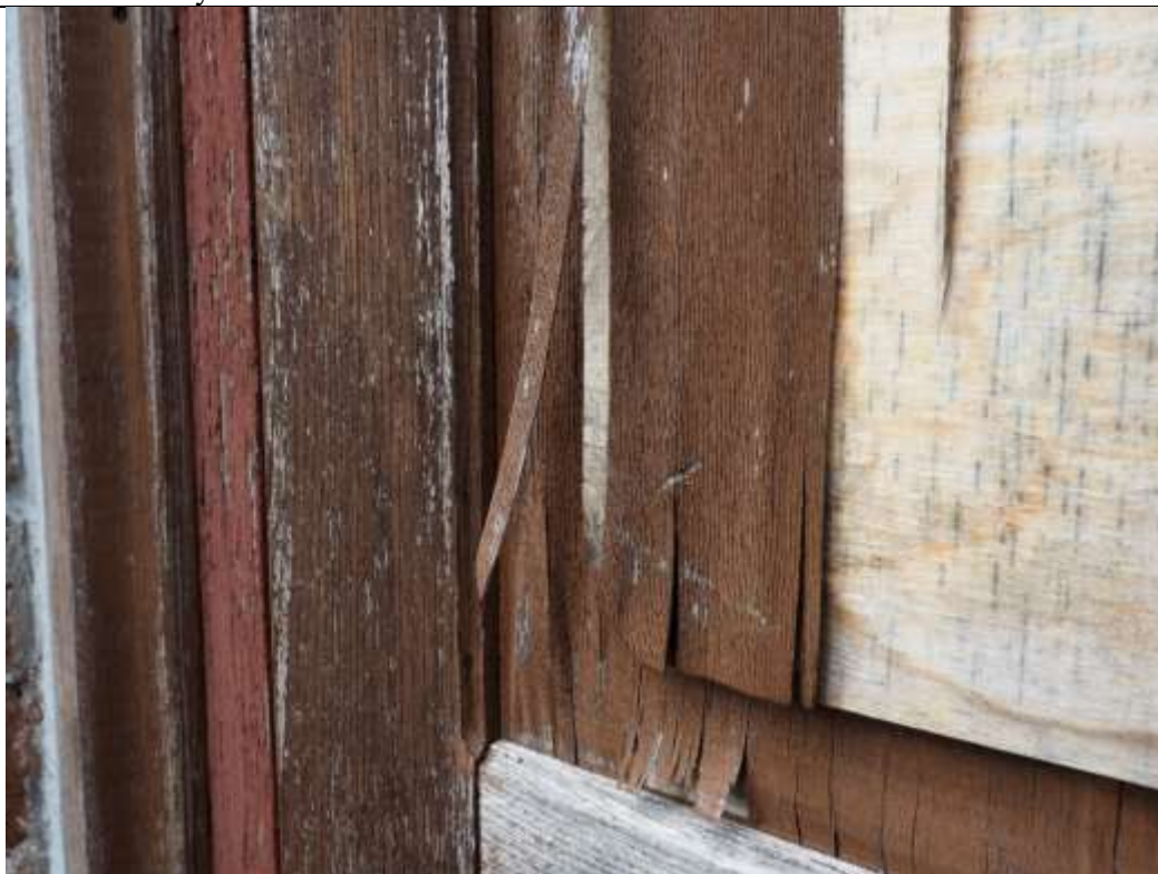
63. Galiny, kościół parafialny pw. Wniebowzięcia Najświętszej Maryi Panny; korpus, elewacja południowa; drzwi, strona zewnętrzna – skrzydło współczesne; rozwarstwienia sklejki we wnętrzu płyciny.
