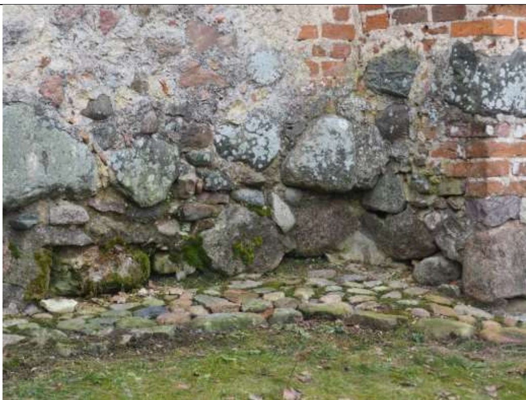
6. Galiny, kościół parafialny pw. Wniebowzięcia Najświętszej Maryi Panny; prezbiterium, elewacja północna, przyziemie, skraj zachodni – zawilgocenie, głębokie ubytki zaprawy i budulca w dolnej strefie muru; opaska z kamienia polnego.
