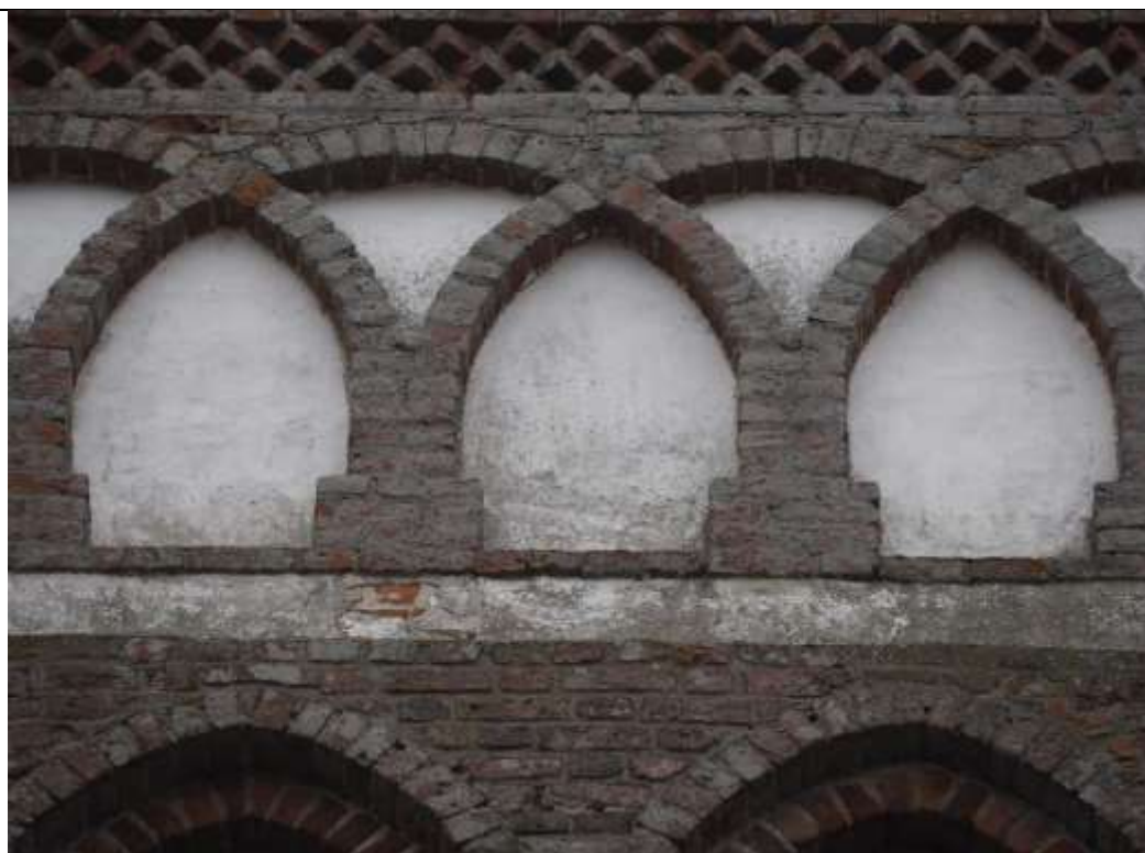
50. Galiny, kościół parafialny pw. Wniebowzięcia Najświętszej Maryi Panny; elewacja zachodnia, szczyt – współczesne nawarstwienia, odspojenia, ubytki wypraw.
