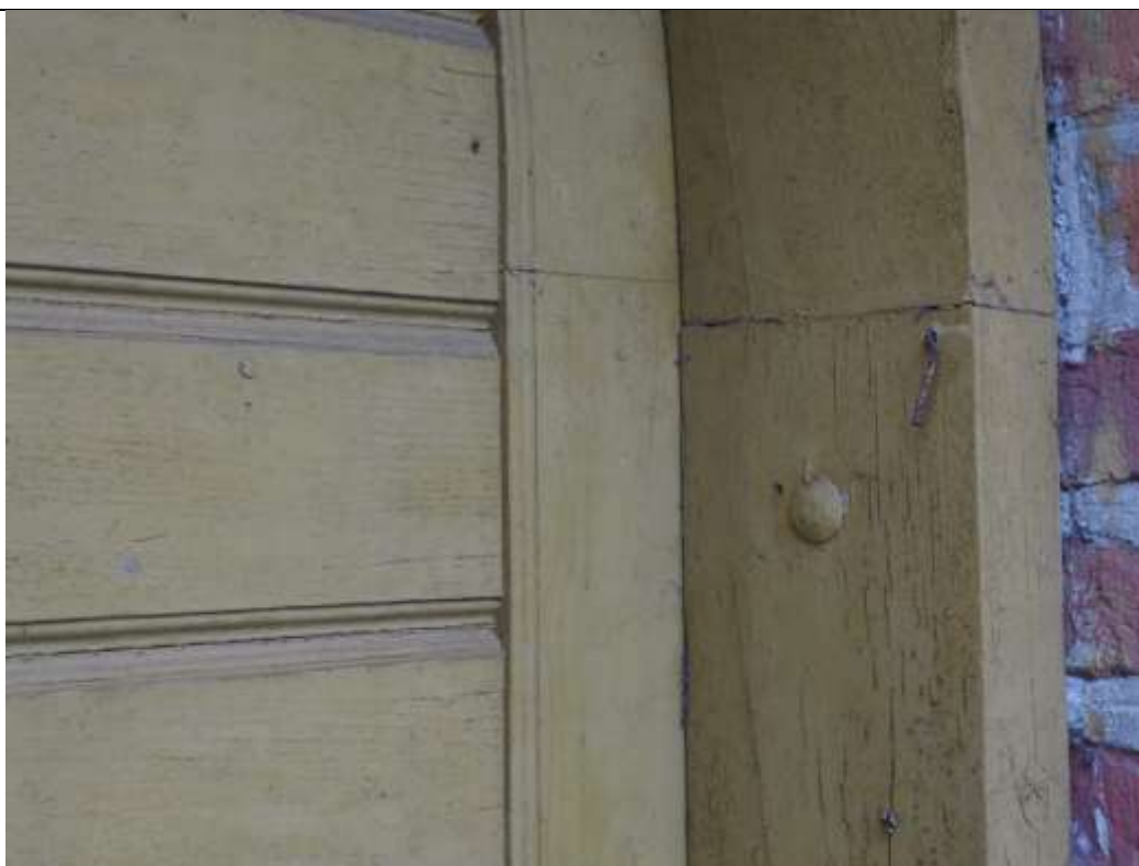
74. Galiny, kościół parafialny pw. Wniebowzięcia Najświętszej Maryi Panny; kruchta, elewacja północna, część wschodnia; drzwi, strona zewnętrzna – powierzchniowe spękania drewna; współczesne przemalowania elementów konstrukcji.
