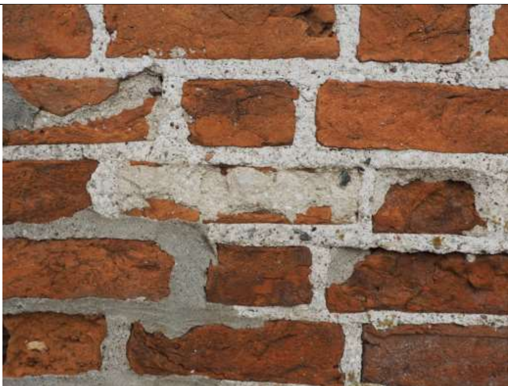
18. Galiny, kościół parafialny pw. Wniebowzięcia Najświętszej Maryi Panny; wieża, elewacja zachodnia, kondygnacja I, przyziemie, część południowa – XIX- wieczne uzupełnienia budulca zaprawą wapienną; współczesne uzupełnienia spoinowań zaprawą cementową.
