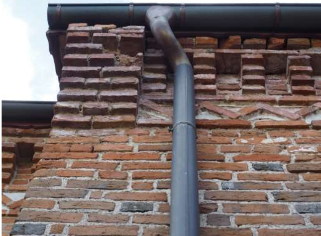
25. Galiny, kościół parafialny pw. Wniebowzięcia Najświętszej Maryi Panny; korpus, elewacja północna, zwieńczenie, skraj wschodni – głębokie ubytki zapraw i budulca w obrębie elementów wieńczących.
