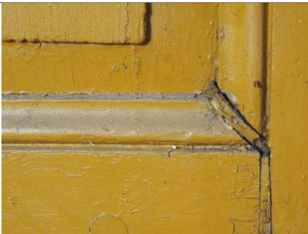
68. Galiny, kościół parafialny pw. Wniebowzięcia Najświętszej Maryi Panny; korpus, elewacja południowa; drzwi, strona wewnętrzna – szczeliny w połączeniach ramiaków skrzydeł usztywnione fragmentami drewna.
