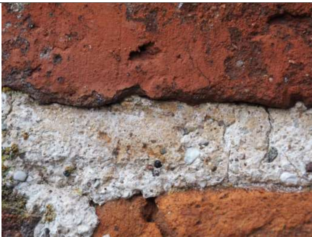
16. Galiny, kościół parafialny pw. Wniebowzięcia Najświętszej Maryi Panny; wieża, elewacja południowa, przyziemie, część zachodnia – pierwotne spoinowanie wątku ceglanego; relikty czerwonej monochromii.
