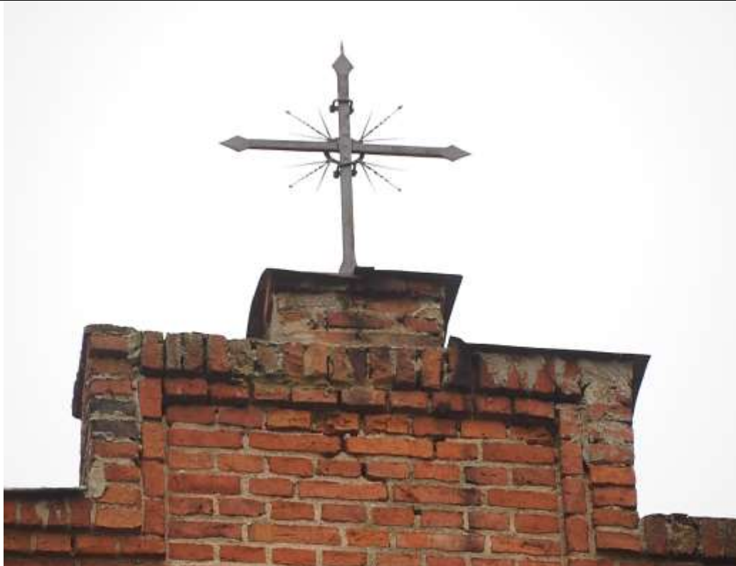
90. Galiny, kościół parafialny pw. Wniebowzięcia Najświętszej Maryi Panny; prezbiterium, elewacja wschodnia, szczyt; zwieńczenie – korozja elementów krzyża; pozostawione zaciski odgromowe.
