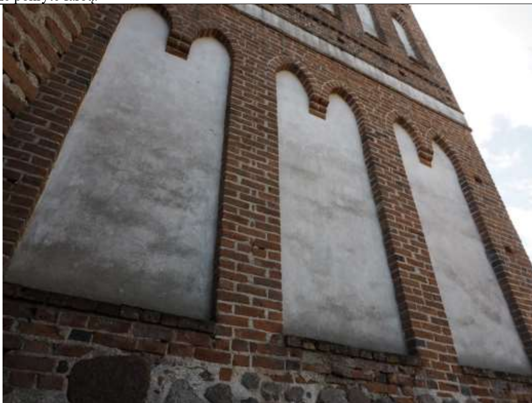
47. Galiny, kościół parafialny pw. Wniebowzięcia Najświętszej Maryi Panny; wieża, elewacja północna, kondygnacja I, powyżej przyziemia – zawilgocenie wypraw w okolicach parapetów.
