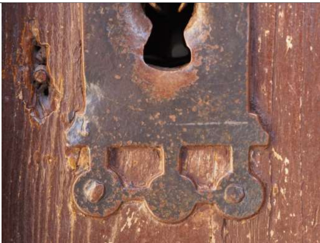
57. Galiny, kościół parafialny pw. Wniebowzięcia Najświętszej Maryi Panny; elewacja zachodnia; drzwi – powierzchniowe spękania, uszkodzenia mechaniczne drewna w okolicy zamka.
