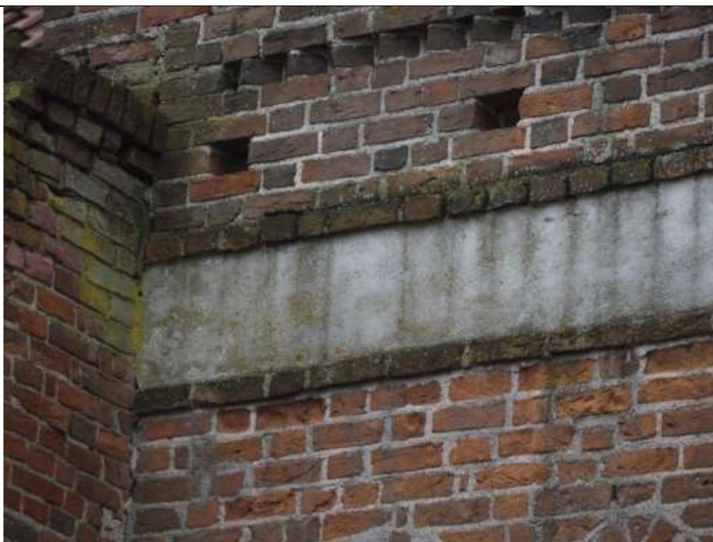
48. Galiny, kościół parafialny pw. Wniebowzięcia Najświętszej Maryi Panny; wieża, elewacja północna, kondygnacje I-II, część wschodnia – zacieki i skupiska porostów na powierzchni tynkowanego fryzu pasowego.
