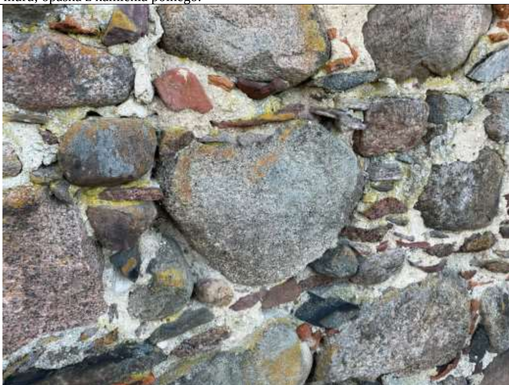
7. Galiny, kościół parafialny pw. Wniebowzięcia Najświętszej Maryi Panny; korpus, elewacja południowa, przyziemie, część środkowa – głębokie ubytki zapraw; odspojenia budulca.
