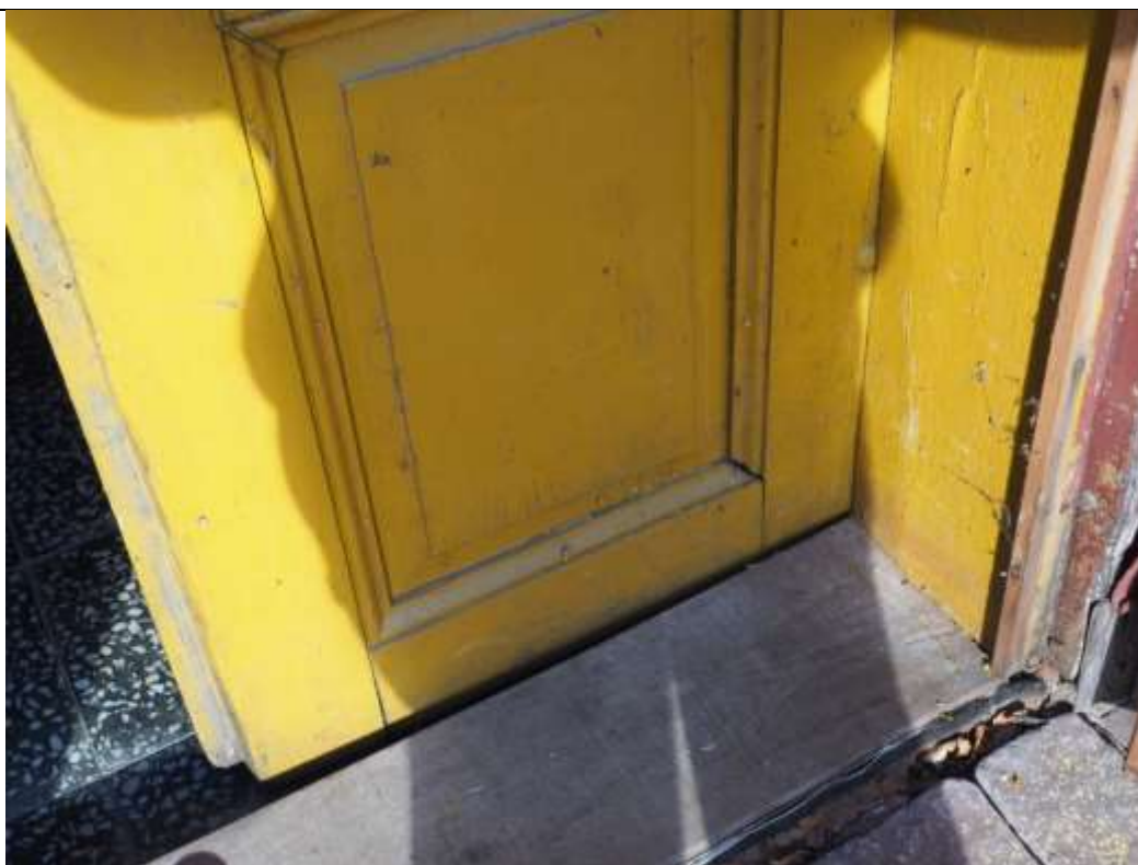
64. Galiny, kościół parafialny pw. Wniebowzięcia Najświętszej Maryi Panny; korpus, elewacja południowa; drzwi, strona wewnętrzna – odkształcenia konstrukcji skrzydeł.
