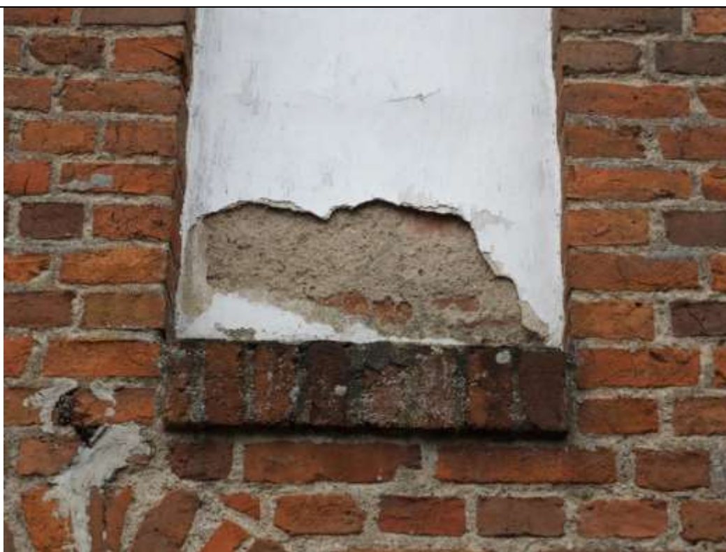
43. Galiny, kościół parafialny pw. Wniebowzięcia Najświętszej Maryi Panny; kruchta, elewacja północna, kondygnacja II, część wschodnia – odspojenia i ubytki tynku wapiennego w dolnej części blendy.
