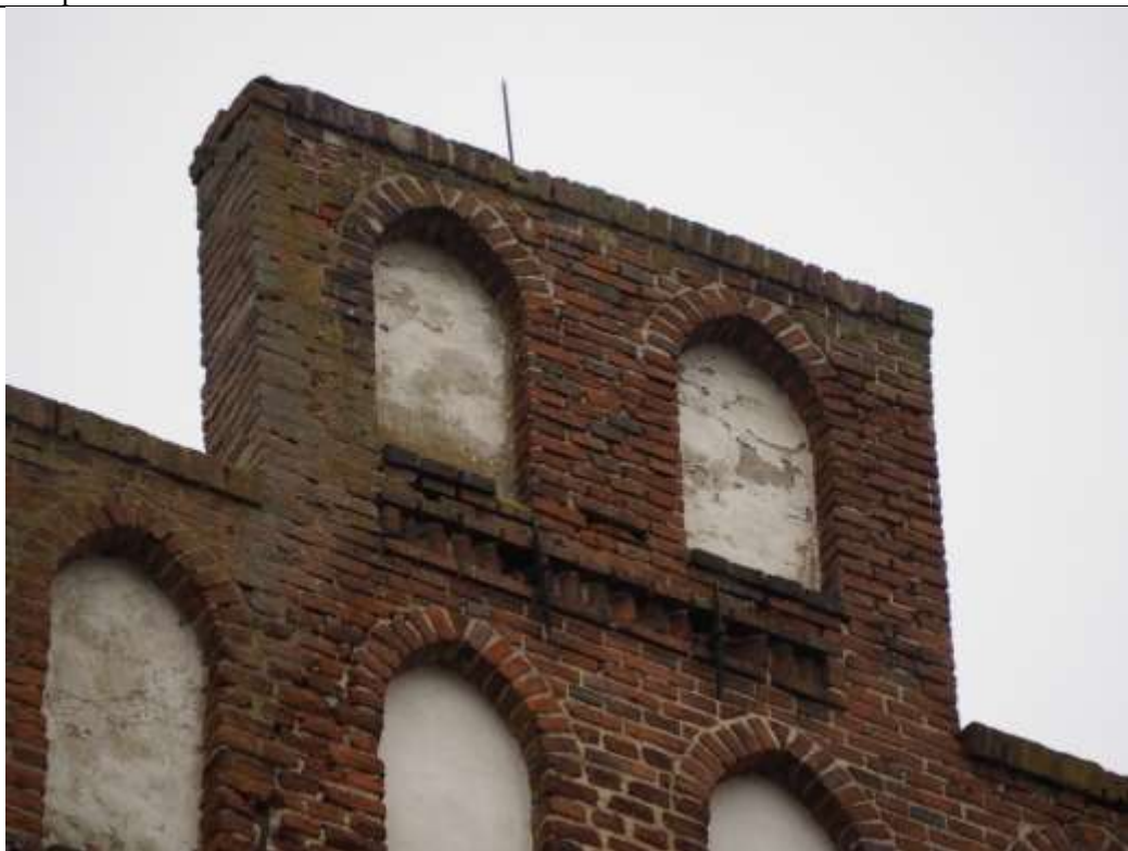
39. Galiny, kościół parafialny pw. Wniebowzięcia Najświętszej Maryi Panny; wieża, elewacja północna, szczyt, część środkowa – brak obróbek blacharskich; odspojenia, ubytki budulca w obrębie nakryw stopni i parapetów.
