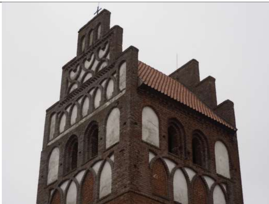
31. Galiny, kościół parafialny pw. Wniebowzięcia Najświętszej Maryi Panny; wieża, elewacje zachodnia i południowa, kondygnacja III – intensywne nawarstwienia wątków ceglanych i wypraw.
