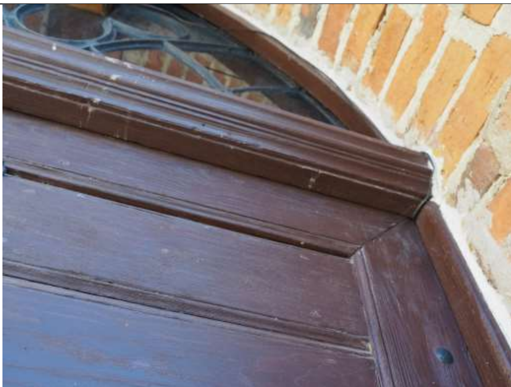
56. Galiny, kościół parafialny pw. Wniebowzięcia Najświętszej Maryi Panny; elewacja zachodnia; drzwi – uszkodzenia profili ślemienia i deskiowania płyciny.
