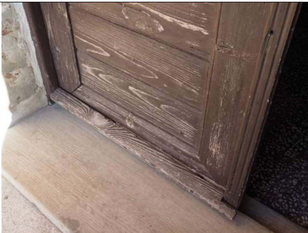
58. Galiny, kościół parafialny pw. Wniebowzięcia Najświętszej Maryi Panny; elewacja zachodnia; drzwi – uszkodzenia elementów w dolnej części skrzydła.
