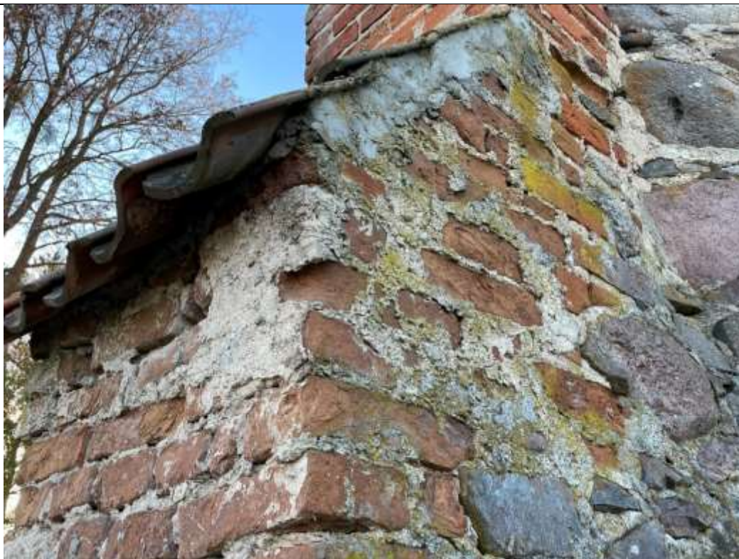
22. Galiny, kościół parafialny pw. Wniebowzięcia Najświętszej Maryi Panny; prezbiterium, elewacja wschodnia, przyziemie, skraj południowy –XIX- wieczne uzupełnienia na powierzchni przypory zaprawą wapienną; współczesna nakrywa z dachówek na zaprawie cementowej.
