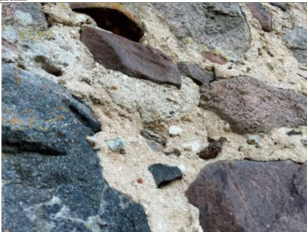
17. Galiny, kościół parafialny pw. Wniebowzięcia Najświętszej Maryi Panny; prezbiterium, elewacja południowa, przyziemie, część środkowa – XIX- wieczne uzupełnienia wątku kamiennego wykonane zaprawą wapienną.
