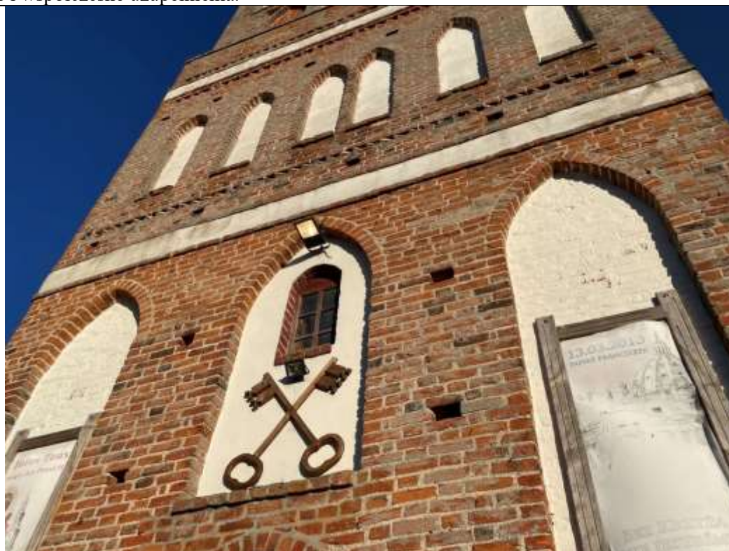
27. Galiny, kościół parafialny pw. Wniebowzięcia Najświętszej Maryi Panny; wieża elewacja zachodnia, kondygnacje I-II – powierzchnia wątku ceglanego pokryta porostami.
