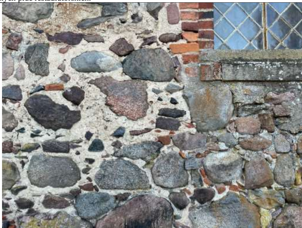
13. Galiny, kościół parafialny pw. Wniebowzięcia Najświętszej Maryi Panny; prezbiterium, elewacja południowa, część środkowa – ubytki wątku kamiennego; współczesne uzupełnienia zaprawą cementową u podstawy otworu okiennego.
