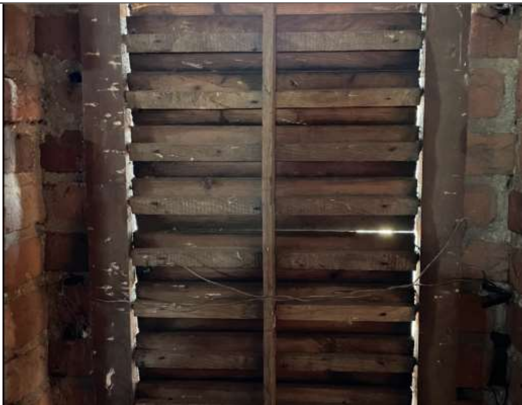
88. Galiny, kościół parafialny pw. Wniebowzięcia Najświętszej Maryi Panny; wieża, elewacja północna, kondygnacja III (IV), część wschodnia; okiennica, strona wewnętrzna – konstrukcja współczesna; prowizoryczne mocowanie przy pomocy drutu.
