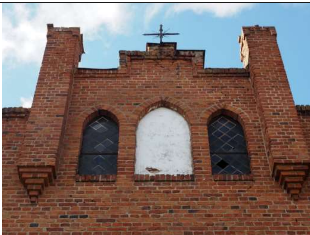
32. Galiny, kościół parafialny pw. Wniebowzięcia Najświętszej Maryi Panny; prezbiterium, elewacja wschodnia, szczyt, część środkowa – rozwarstwienie konstrukcji murowej; uszkodzenia elementów wieńczących, nakryw stopni i sterczyn.
