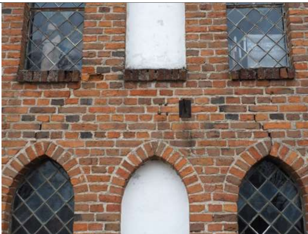
10. Galiny, kościół parafialny pw. Wniebowzięcia Najświętszej Maryi Panny; zakrystia, elewacja północna, kondygnacje I-II – spękania muru na osiach otworów okiennych.
