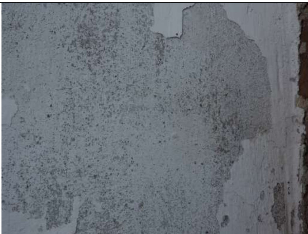
42. Galiny, kościół parafialny pw. Wniebowzięcia Najświętszej Maryi Panny; zakrystia, elewacja północna, kondygnacja I, część środkowa – powierzchnia tynku pokryta warstwami przemalowań.
