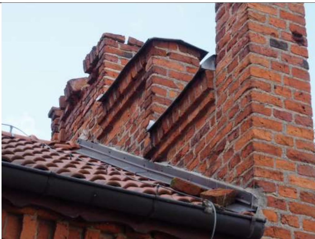
36. Galiny, kościół parafialny pw. Wniebowzięcia Najświętszej Maryi Panny; kruchta, szczyt, strona tylna – ubytki obróbek blacharskich; odspojenia, ubytki zapraw i budulca w obrębie nakrywy.
