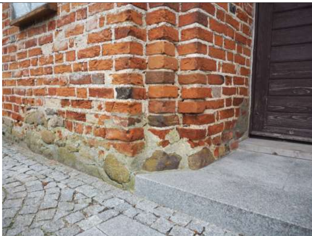
26. Galiny, kościół parafialny pw. Wniebowzięcia Najświętszej Maryi Panny; wieża, elewacja zachodnia, kondygnacja I, przyziemie, część środkowa – głębokie ubytki spoinowań i budulca; historyczne i współczesne uzupełnienia.
