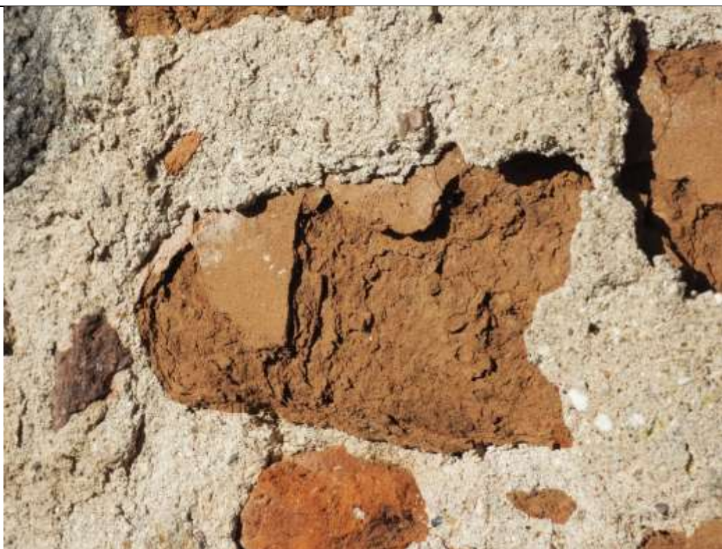
14. Galiny, kościół parafialny pw. Wniebowzięcia Najświętszej Maryi Panny; korpus, elewacja południowa, przyziemie, część środkowa – osłabienie strukturalne, ubytki zaprawy i budulca ceramicznego
