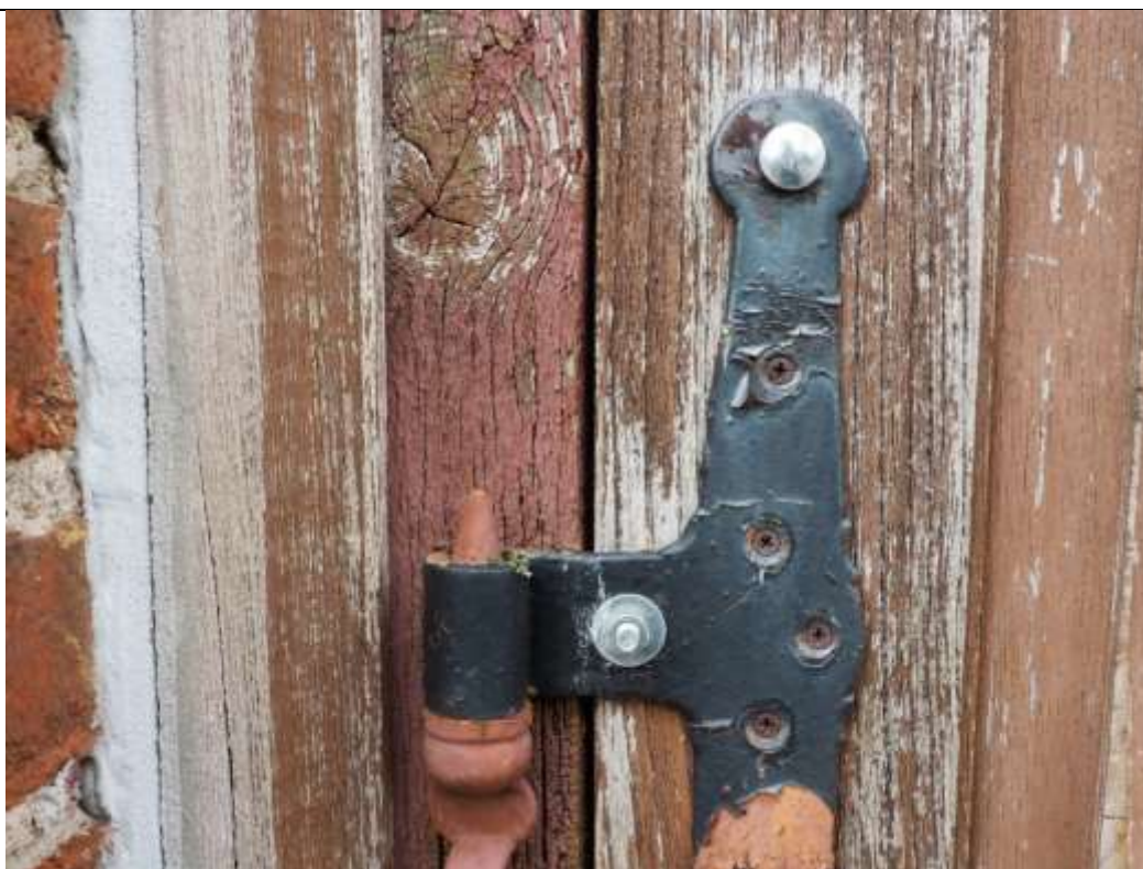
62. Galiny, kościół parafialny pw. Wniebowzięcia Najświętszej Maryi Panny; korpus, elewacja południowa; drzwi, strona zewnętrzna – spęknięcia drewna, uszkodzenia powłoki malarskiej ościeżnicy; współczesne elementy zawisów.
