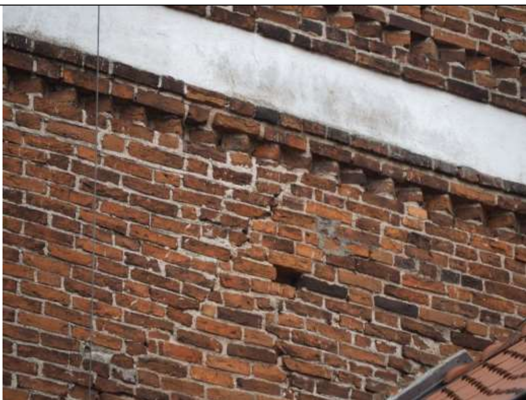
11. Galiny, kościół parafialny pw. Wniebowzięcia Najświętszej Maryi Panny; wieża, elewacja wschodnia, kondygnacja II, część południowa – szczeliny, rozwarstwienia muru powyżej dachu korpusu.
