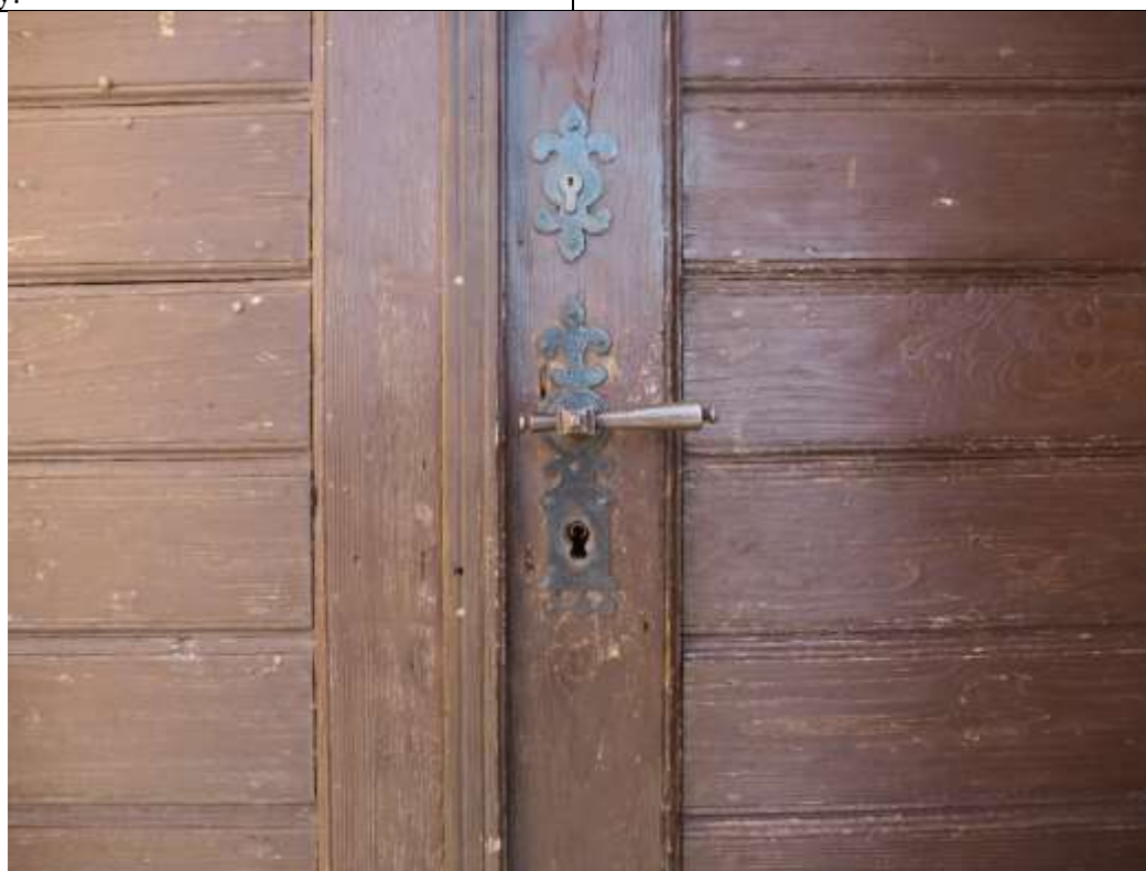
54. Galiny, kościół parafialny pw. Wniebowzięcia Najświętszej Maryi Panny; elewacja zachodnia; drzwi – uszkodzenia powłoki malarskiej na zewnętrznej stronie skrzydeł.
