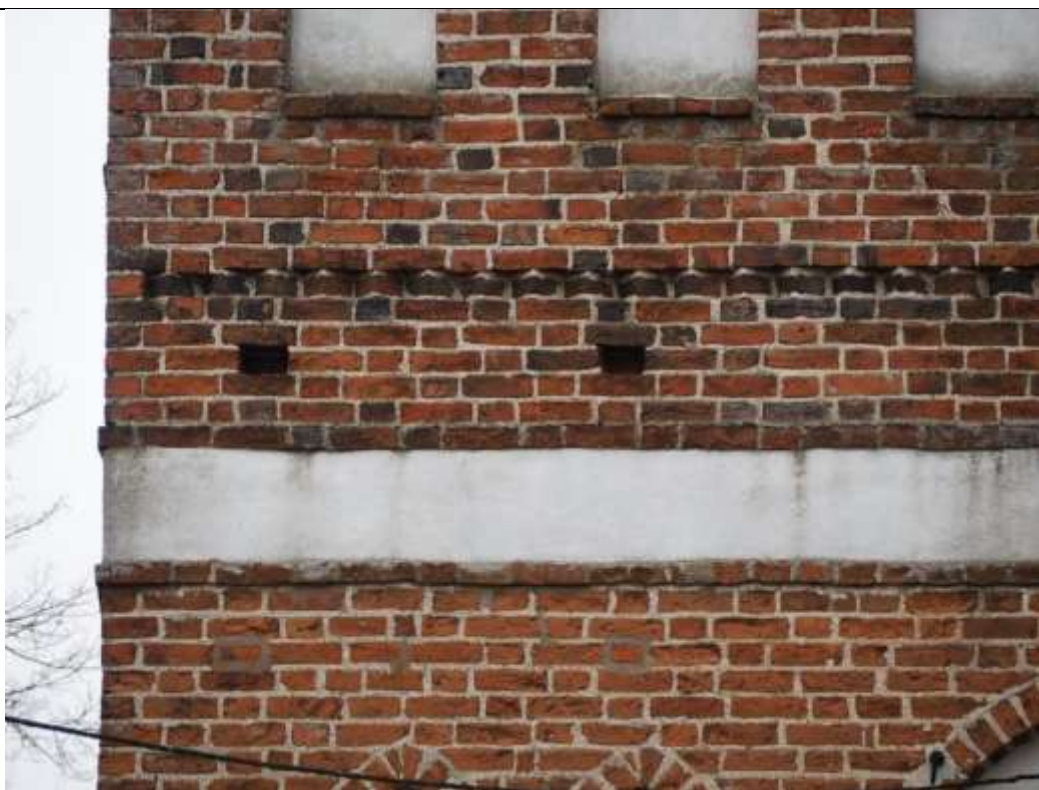
28. Galiny, kościół parafialny pw. Wniebowzięcia Najświętszej Maryi Panny; elewacja zachodnia, kondygnacje I-II, część północna – ciemne przebarwienia, ubytki zapraw i budulca w okolicach parapetów, fryzów i gzymsów.
