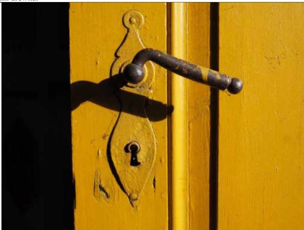
69. Galiny, kościół parafialny pw. Wniebowzięcia Najświętszej Maryi Panny; korpus, elewacja południowa; drzwi, strona wewnętrzna – uszkodzenia mechaniczne drewna w okolicy zamka; korozja elementów metalowych.
