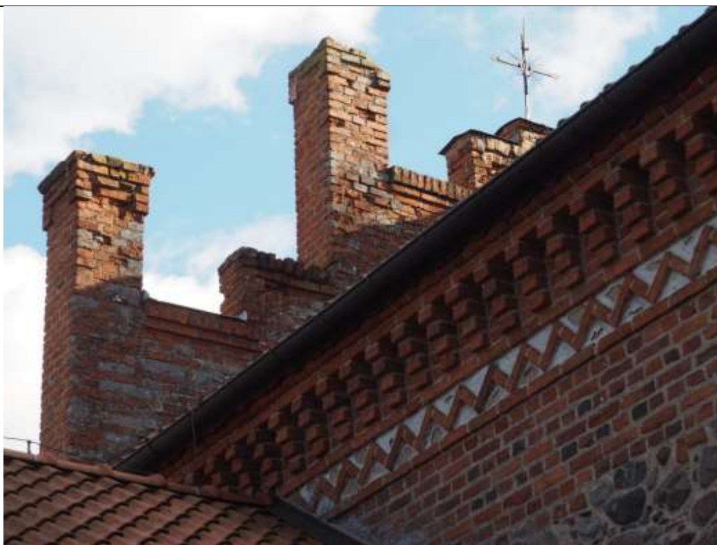
34. Galiny, kościół parafialny pw. Wniebowzięcia Najświętszej Maryi Panny; prezbiterium, szczyt, strona tylna – odspojenia, ubytki zapraw i budulca w obrębie elementów wieńczących.
