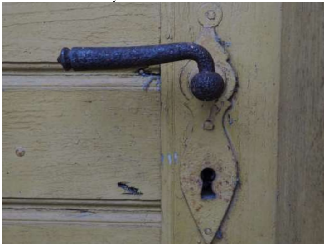
75. Galiny, kościół parafialny pw. Wniebowzięcia Najświętszej Maryi Panny; kruchta, elewacja północna, część zachodnia; drzwi, strona zewnętrzna – uszkodzenia mechaniczne drewna w okolicy zamka; korozja elementów metalowych.
