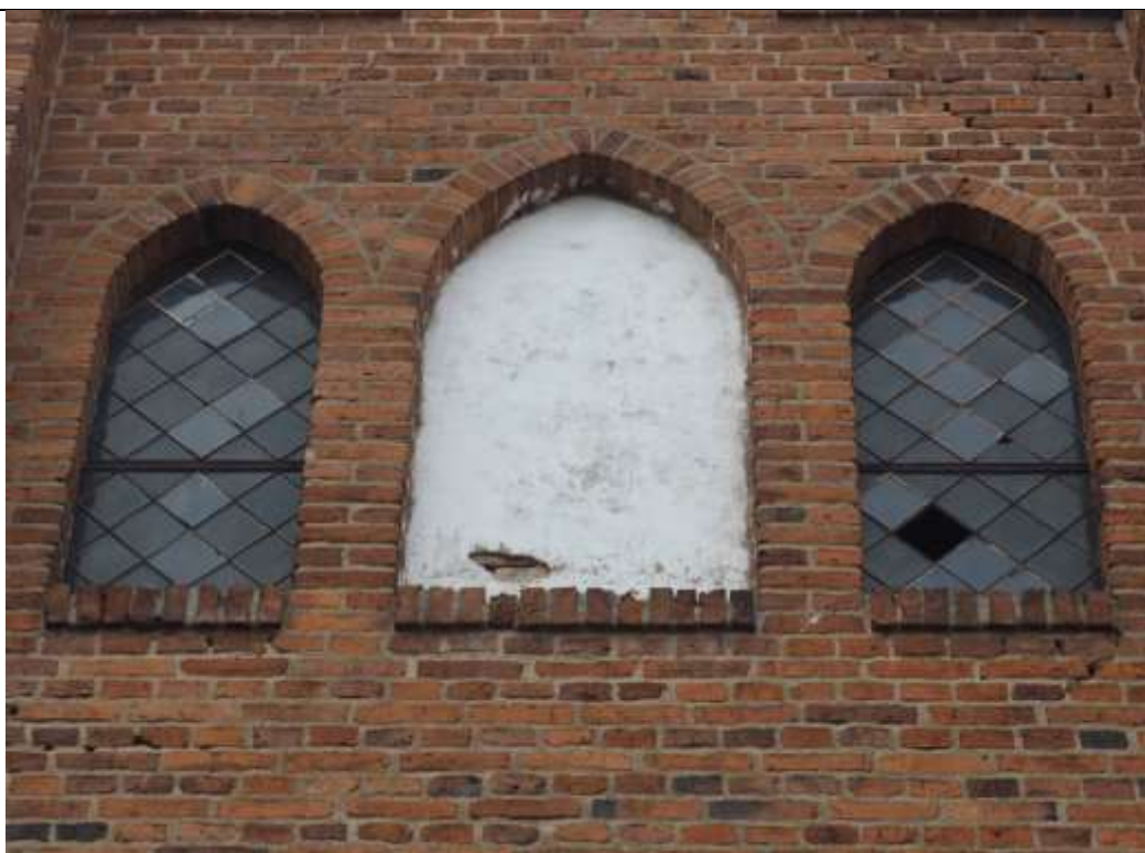
40. Galiny, kościół parafialny pw. Wniebowzięcia Najświętszej Maryi Panny; kruchta, elewacja północna, kondygnacja II, część środkowa – odspojenia i ubytki tynku w dolnej części blendy.
