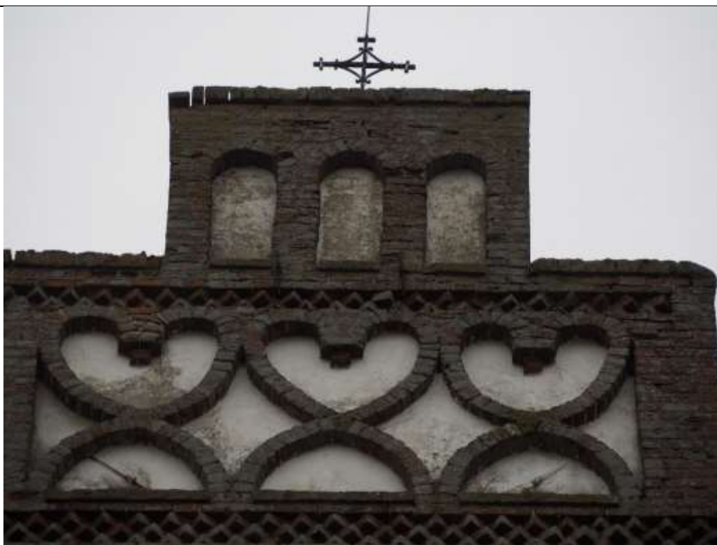
38. Galiny, kościół parafialny pw. Wniebowzięcia Najświętszej Maryi Panny; wieża, elewacja zachodnia, szczyt, część środkowa – brak obróbek blacharskich; odspojenia i ubytki budulca w obrębie nakryw stopni.
