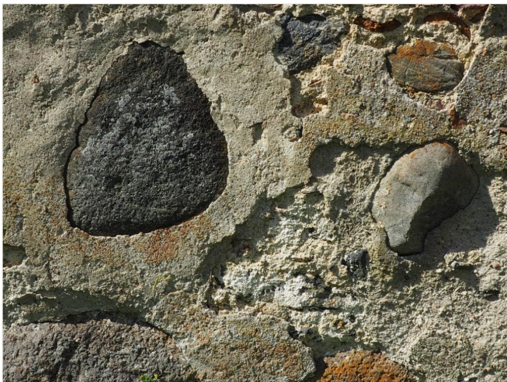
36. Wozławki, kościół parafialny p.w. Św. Antoniego Opata; wieża - elewacja południowa (przyziemie, część zachodnia); cokół. Postępująca dezintegracja zaprawy; powierzchniowe ubytki historycznych spoinowań cementowo – wapiennych cokołu; skupiska mikroorganizmów – roślinnych.
