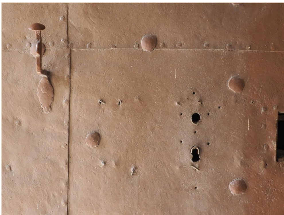
49. Wozławki, kościół parafialny p.w. Św. Antoniego Opata; wieża – drzwi; awers (elewacja zachodnia, przyziemie). Przykład i stan zachowania historycznych okuć uchwytowych oraz zamykających (pochwyty; brakujące elementy zamka, sztyl oraz kłamek przegubowa).
