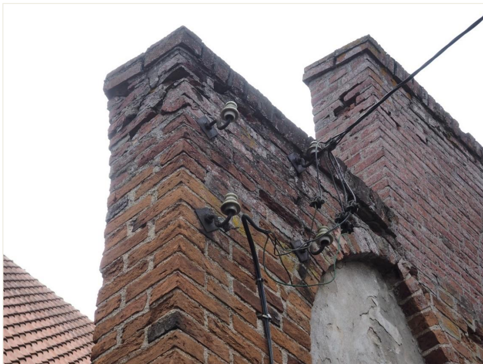
28. Wozławki, kościół parafialny p.w. Św. Antoniego Opata; zakrystia - elewacja północna; fragment szczytu (zwieńczenie, skraj wschodni). Głębokie ubytki zapraw murarskich i silnie rozluźniona struktura murowa zrekonstruowanych stopni szczytu na skutek zamakania wodą opadową; poniżej ubytki wążku gotyckiego; pozostawione lub ułożone bezładnie elementy instalacji elektrycznej, przewody i haki dystansowe.
