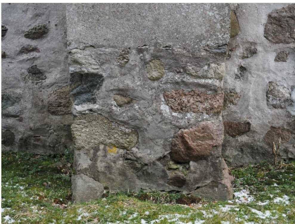
21. Wozławki, kościół parafialny p.w. Św. Antoniego Opata; korpus - elewacja północna (przyziemie, część środkowa); cokół przypory. Historyczne uzupełnienia spoin wykonane zaprawą cementowo – wapienną; głębokie ubytki zaprawy w niższych partiach cokołu; powierzchniowe uzupełnienia szlichtą lub zacierką cementową.
