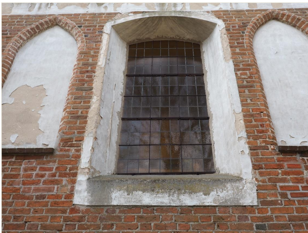
10. Wozławki, kościół parafialny p.w. Św. Antoniego Opata; korpus - elewacja wschodnia (część środkowa, powyżej strefy cokołowej). Fragmenty lica ceglanoego i elementy tynkowane; rozległe, nieestetyczne uzupełnienia wątku ceglanoego wykonane zaprawą cementową; zawilgocenie i postępująca dezintegracja wypraw w obrębie fryzu, blend, ościeży otworu okiennego.
