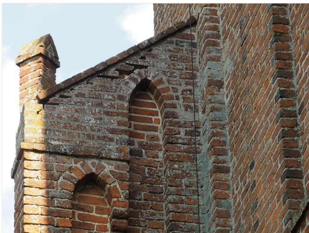
33. Wozławki, kościół parafialny p.w. Św. Antoniego Opata; korpus - elewacja zachodnia (zwieńczenie, strona północna); półszczyt. Głębokie ubytki zapraw murarskich i odspojenie nakrywy ceramicznej; znaczne zawilgocenie murów i skupiska mikroorganizmów roślinnych.
