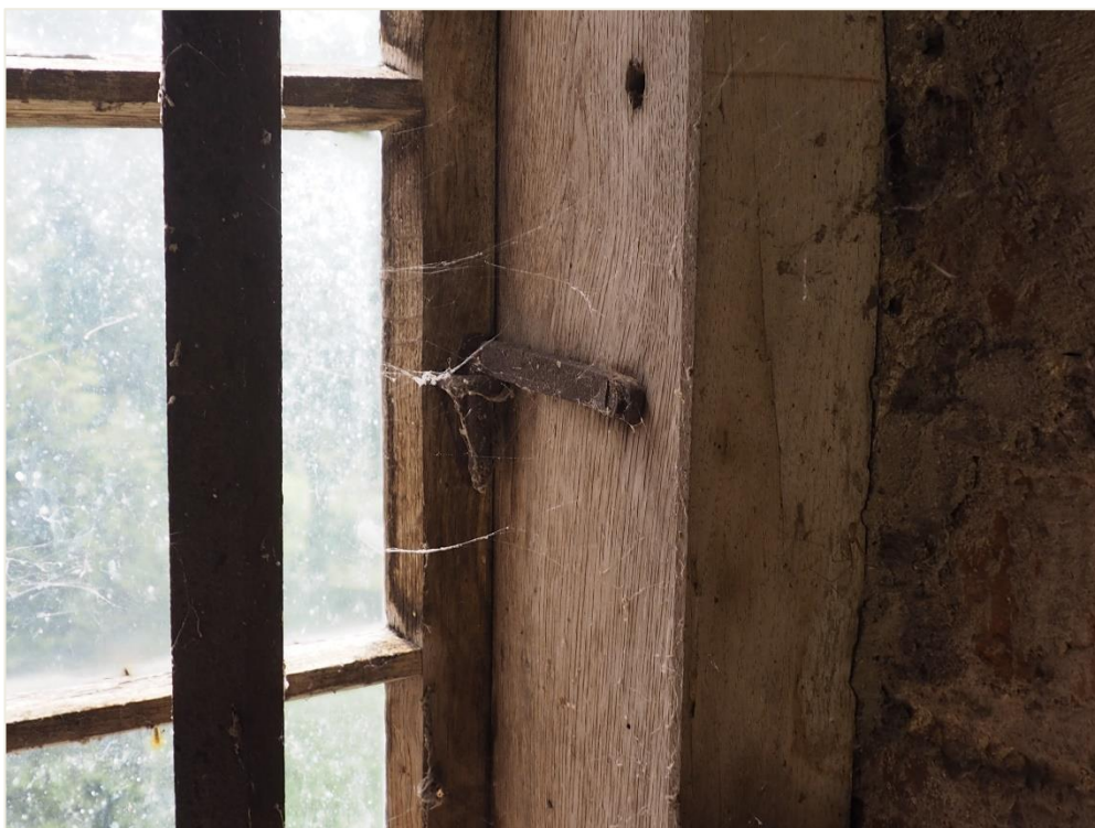
63. Wozławki, kościół parafialny p.w. Św. Antoniego Opata; wieża, elewacja południowa, kondygnacja I, skraj wschodni –okno, rewers (wnętrze piętra 0/I). Przykład i stan zachowania okuć zamykających - mocujących (haczyk okienny - montażowy).
