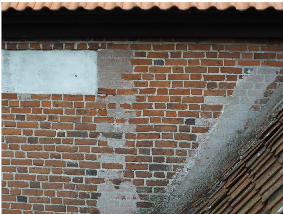
17. Wozławki, kościół parafialny p.w. Św. Antoniego Opata; korpus - elewacja północna; fragment lica ceglano i fryzu (skraj wschodni, nad dachem zakrystii). Historyczne naprawy wątku gotyckiego wykonane zaprawą cementowo – wapienną, z imitacją układu, koloru cegieł i spoinowań; współczesne przemalowania tynków we wnętrzu fryzu.
