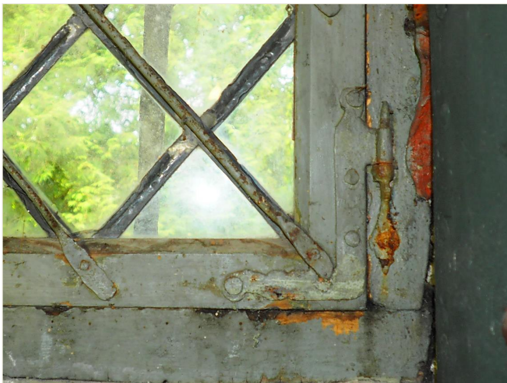
56. Wozławki, kościół parafialny p.w. Św. Antoniego Opata; zakrystia – okno, rewers (wnętrze zakrystii). Przykład i stan zachowania historycznych okuć łączących oraz wzmacniających (zawiasy, wiatrownice).
