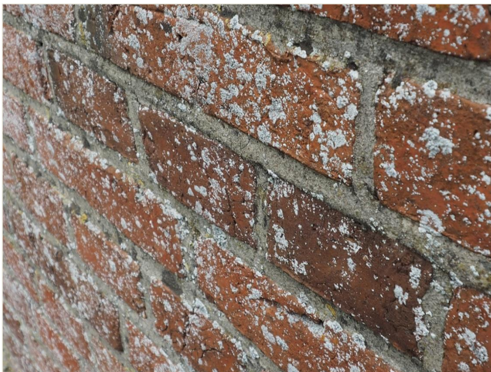
29. Wozławki, kościół parafialny p.w. Św. Antoniego Opata; zakrystia - elewacja północna; szczyt (zwieńczenie, część środkowa), fragment lica. Wążek ceglany w obrębie zrekonstruowanych partii szczytu; ciemne przebarwienia, skupiska mikroorganizmów roślinnych.
