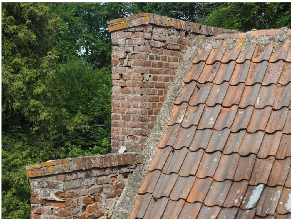
30. Wozławki, kościół parafialny p.w. Św. Antoniego Opata; zakrystia - elewacja północna; szczyt (zwieńczenie, strona tylna, część zachodnia). Odspojenia, ubytki cegieł i zapraw murarskich; osłabienie struktury murowej spowodowane zamakaniem przez wody opadowe.
