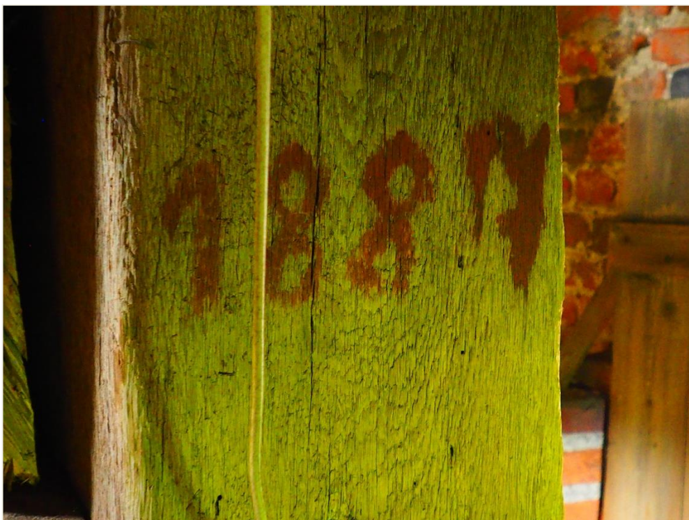
74. Wozławki, kościół parafialny p.w. Św. Antoniego Opata; wieża (wnętrze, piętro V - dzwonnica). Pamiątkowa sygnatura z datą „1887”, odnosząca się do prac remontowych.
