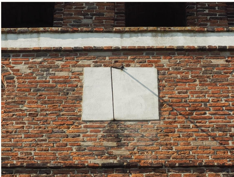
38. Wozławki, kościół parafialny p.w. Św. Antoniego Opata; wieża - elewacja południowa (kondygnacja III); lico i zegar słoneczny. Historyczne uzupełnienia lica cegieł wykonane zaprawą cementowo – wapienną, z resztkami czerwonej warstwy barwnej; skorodowany gnomon zegara, na tarczy silnie zatarte linie godzinowe (wskazówki).
