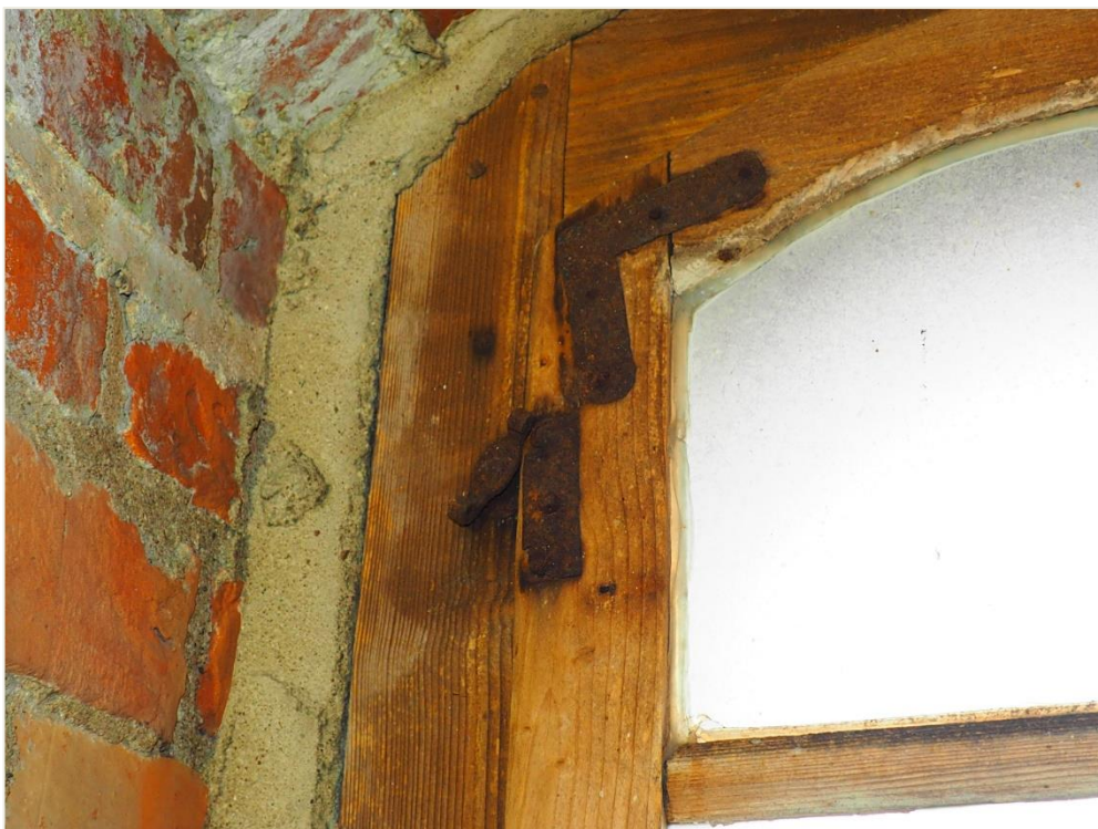
66. Wozławki, kościół parafialny p.w. Św. Antoniego Opata; wieża, elewacja zachodnia, kondygnacja II – okno, rewers (wnętrze piętra I). Przykład i stan zachowania historycznych okuć łączących oraz zamykających (górne, narożnik oraz zakrętka z dociskiem).
