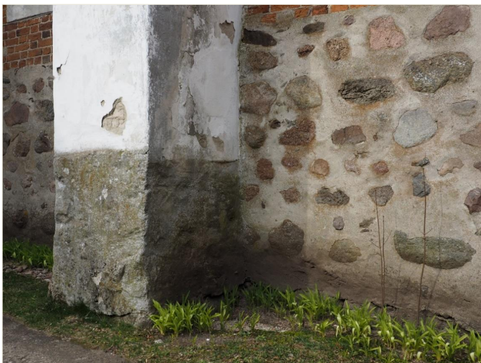
23. Wozławki, kościół parafialny p.w. Św. Antoniego Opata; korpus - elewacja południowa (przyziemie, część wschodnia); fragment przypory. Historyczne spoinowania cementowo – wapienne na cokole przypory zatarte szlichtą cementową; powyżej współczesne, rozległe naprawy tynków z warstwami przemalowań.
