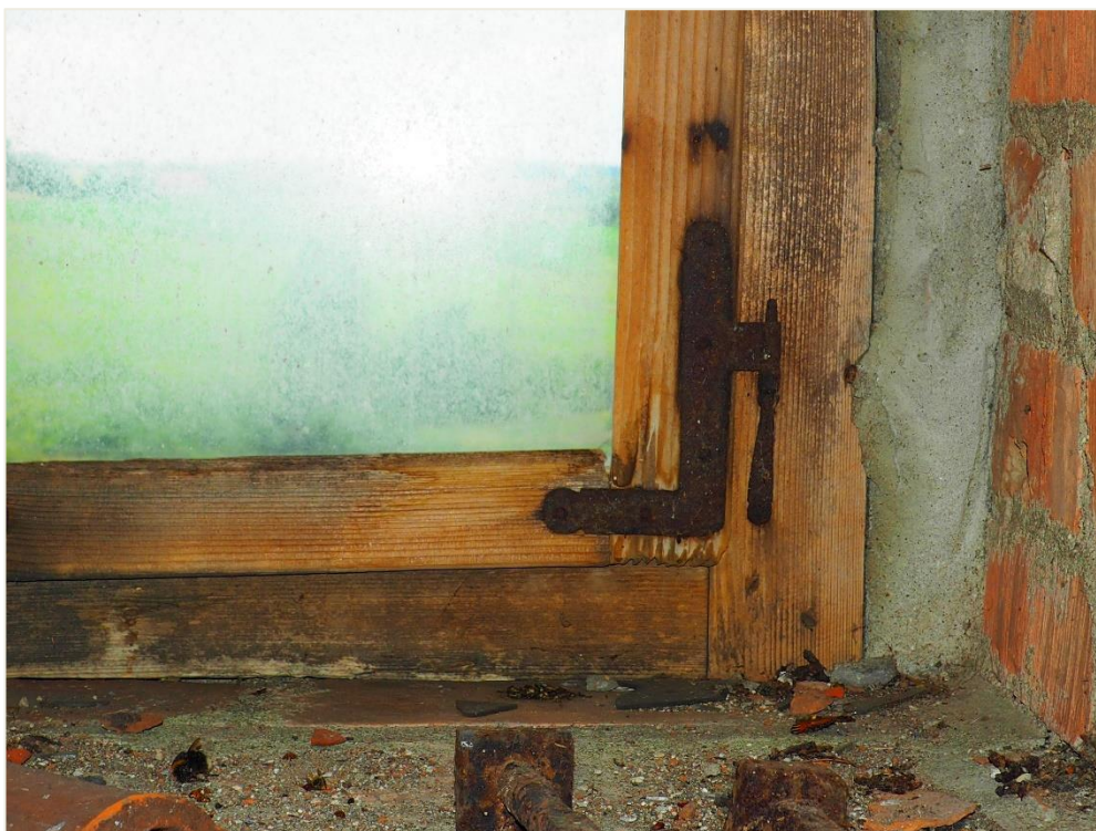
65. Wozławki, kościół parafialny p.w. Św. Antoniego Opata; wieża, elewacja zachodnia, kondygnacja II – okno, rewers (wnętrze piętra I). Przykład i stan zachowania okuć łączących (zawias dolny).
