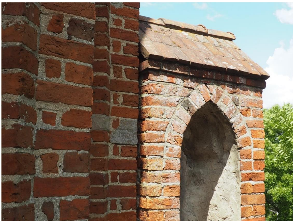
15. Wozławki, kościół parafialny p.w. Św. Antoniego Opata; korpus - elewacja wschodnia; fragment szczytu (poziom I, skraj północny) i zwieńczenia przypory. Rozległe uszkodzenia tynku we wnętrzu przeźrocza; poniżej ceramicznej nakrywy osłabione, silnie spękane lico cegieł, głębokie ubytki spoinowań i skupiska mikroorganizmów roślinnych.
