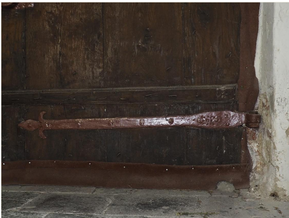
50. Wozławki, kościół parafialny p.w. Św. Antoniego Opata; wieża – drzwi; rewers (wnętrze kruchty wieżowej). Przykład i stan zachowania historycznych okuć łączących (dolny zawias pasowy).
