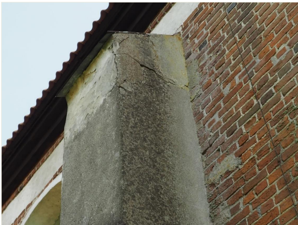
22. Wozławki, kościół parafialny p.w. Św. Antoniego Opata; korpus - elewacja północna (poniżej fryzu, część środkowa); zwieńczenie przypory. Historyczny tynk cementowo – wapienny; skupiska mikroorganizmów roślinnych; odspojenia i głębokie spękania; współczesne uzupełnienia cementowe i opierzenie z blachy.
