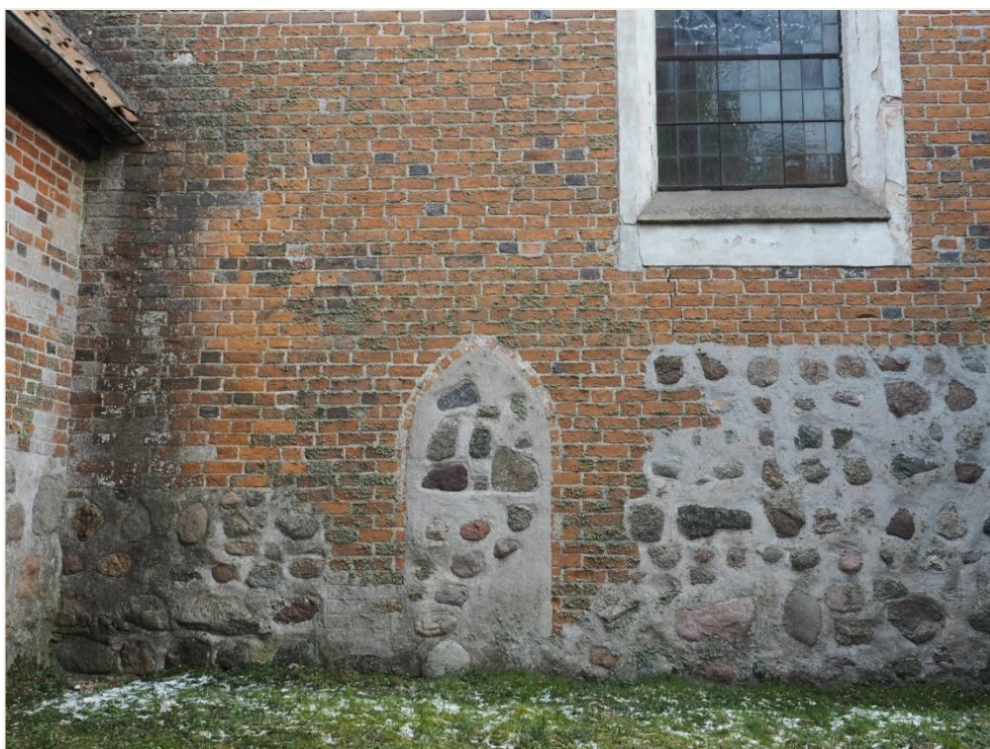
18. Wozławki, kościół parafialny p.w. Św. Antoniego Opata; korpus - elewacja północna (przyziemie, część wschodnia i środkowa). Historyczne uzupełnienia spoin w obrębie cokołu wykonane zaprawą cementowo – wapienną; utrzymujące się zawilgocenie murów; liczne skupiska mikroorganizmów roślinnych.
