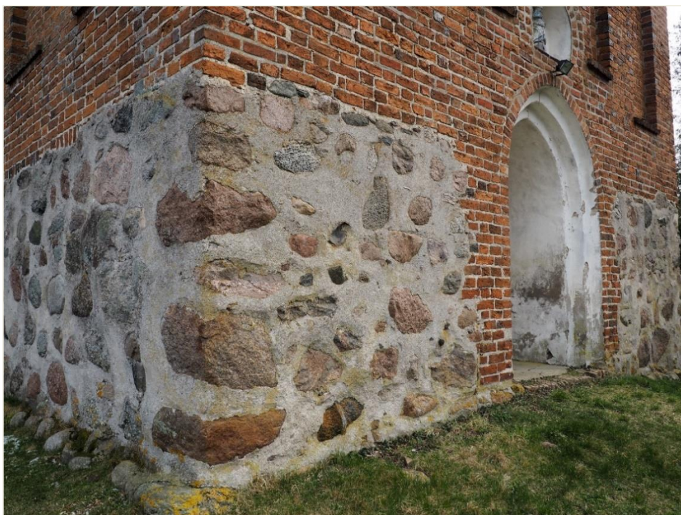
35. Wozławki, kościół parafialny p.w. Św. Antoniego Opata; wieża - elewacja zachodnia (przyziemie); cokół i portal. Historyczne uzupełnienia spoinowań cokołu wykonane zaprawą cementowo – wapienną; współczesne uzupełnienia i przemalowania wypraw tynkarskich na ościeżach portalu.
