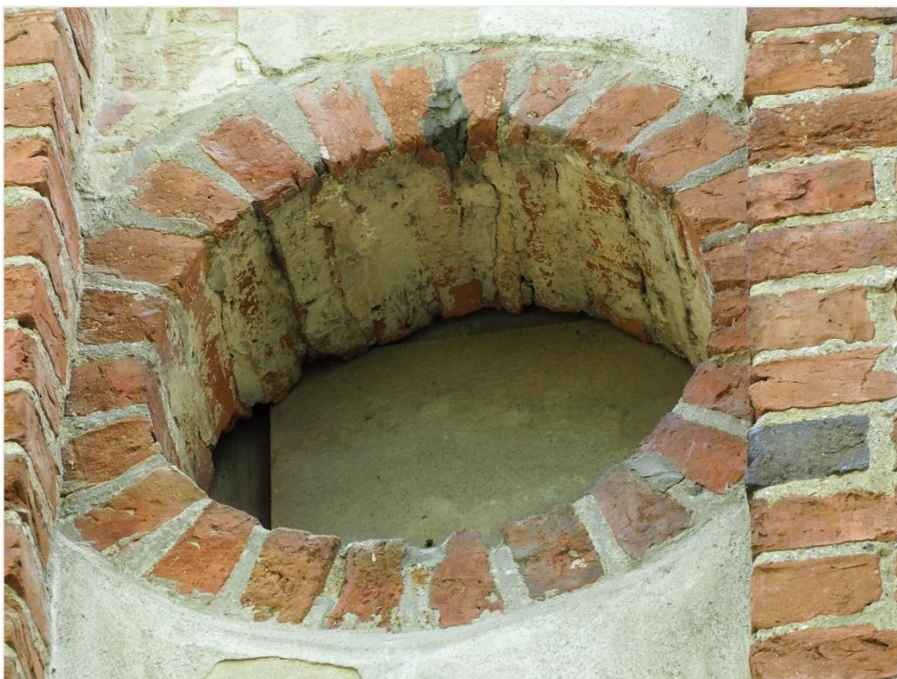
54. Wozławki, kościół parafialny p.w. Św. Antoniego Opata; korpus, elewacja wschodnia, szczyt (poziom I, strona północna) – okno, awers (pro wizoryczne zaślepienie przeźrocza i konstrukcji okna płytą pilśniową).
