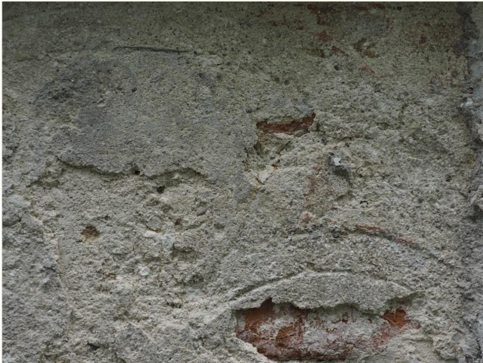
13. Wozławki, kościół parafialny p.w. Św. Antoniego Opata; korpus - elewacja wschodnia; fragment fryzu (poniżej szczytu, odcinek środkowy). Fragmenty tynku średniowiecznego; głębokie ubytki i postępująca dezintegracja zaprawy wapiennej; na powierzchni wyraźne reliktory rytów i barwnego opracowania dekoracji maswerkowej.
