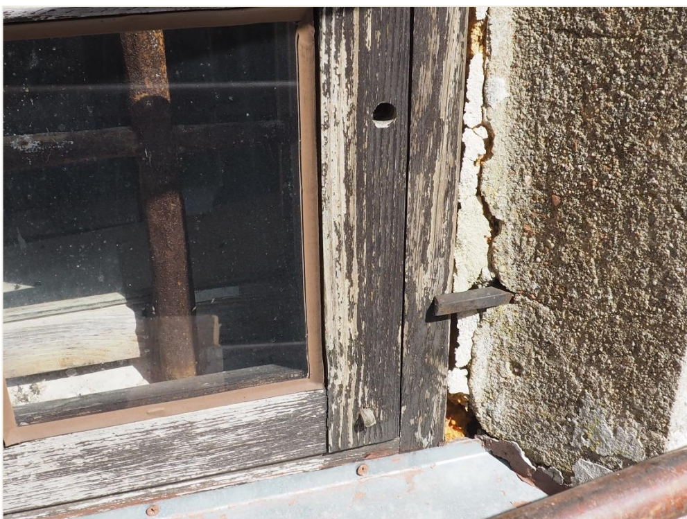
73. Wozławki, kościół parafialny p.w. Św. Antoniego Opata; rotunda/kaplica, elewacja zachodnia – okno, awers. Przykład i stan zachowania współczesnych okuć montażowych oraz zamykających (hak ościeżnicowy, otwór zamka na tzw. „klucz konduktorski”).
