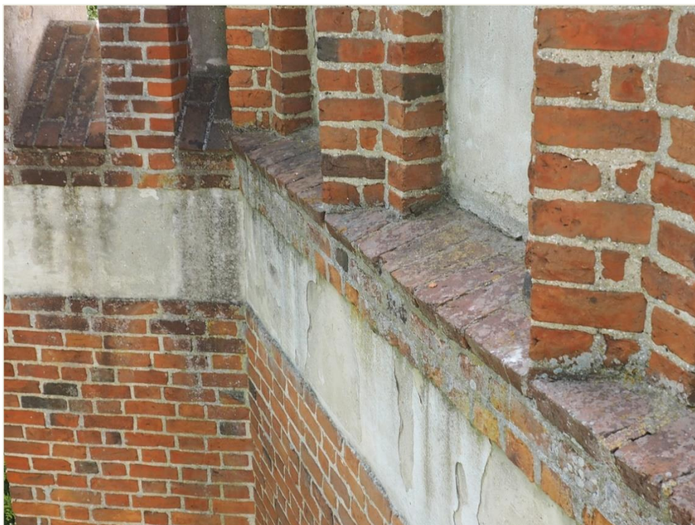
16. Wozławki, kościół parafialny p.w. Św. Antoniego Opata; korpus - elewacja wschodnia; fragment szczytu (poziom I, skraj południowy) i zwieńczenia przypory. Zawilgocenie odsadzki u podstawy szczytu i ceramicznych nakryw przypory; rozległe ciemne przebarwienia i skupiska mikroorganizmów roślinnych; ubytki wypraw tynkarskich na skutek zamakania wodą opadową.
