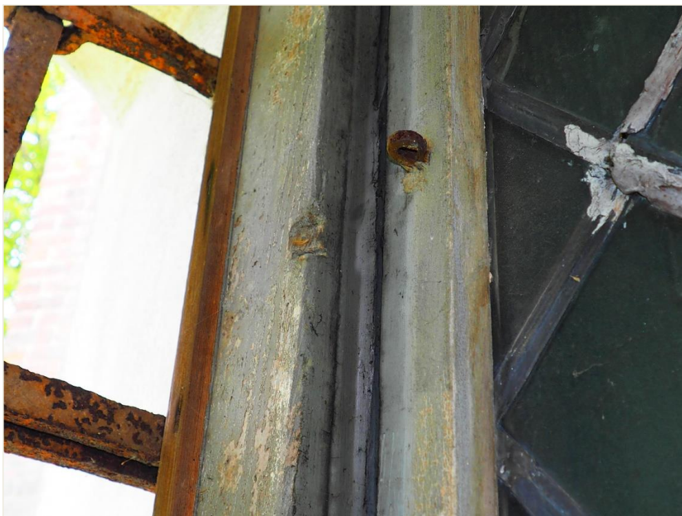
60. Wozławki, kościół parafialny p.w. Św. Antoniego Opata; zakrystia – okno, rewers (wnętrze zakrystii). Przykład i stan zachowania historycznych okuć zabezpieczających (brak haczyka przeciwiatrowego).
