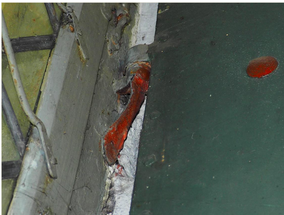
59. Wozławki, kościół parafialny p.w. Św. Antoniego Opata; zakrystia – okno, rewers (wnętrze zakrystii). Przykład i stan zachowania historycznych okuć łączących (zawias okienny).
