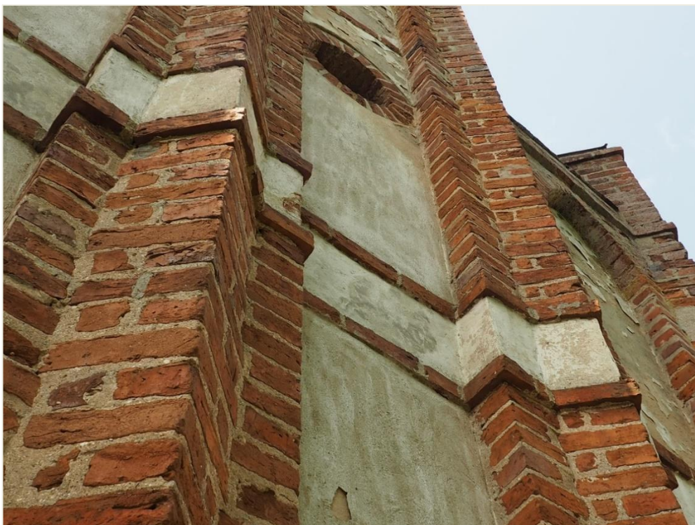
11. Wozławki, kościół parafialny p.w. Św. Antoniego Opata; korpus - elewacja wschodnia; fragment szczytu (poziom I/II, strona północna). Lokalne naprawy wątków średniowiecznych wykonane zaprawą cementową; odspojenia i rozległe ubytki wypraw wapiennych i cementowo – wapiennych pokrywających tynki średniowieczne, na powierzchni współczesne przemalowania.
