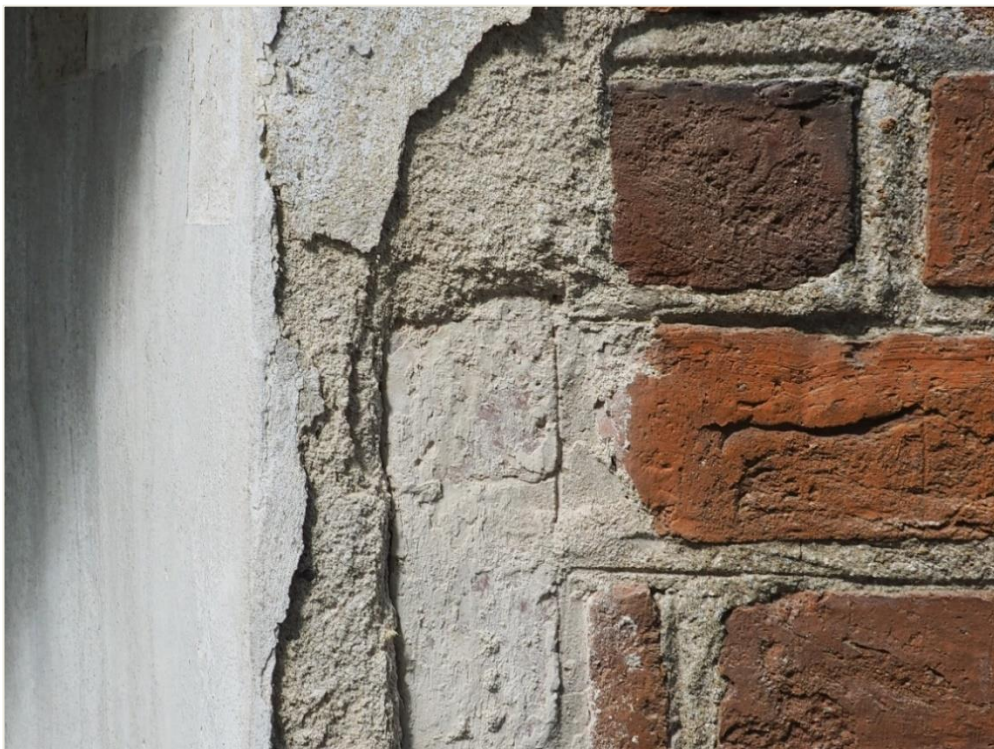
14. Wozławki, kościół parafialny p.w. Św. Antoniego Opata; korpus - elewacja wschodnia; otwór okienny (zewnątrzna krawędź ościeża oraz fragment lica ceglanego). Silnie zdeintegrowany, osypujący się tynk wapienny tworzący nowożytnie opracowanie ościeży; pozostałości wcześniejszego wykończenia z warstwami pobiał wapiennych; fragment wążku gotyckiego z zachowanym kształtem spoinowań.
