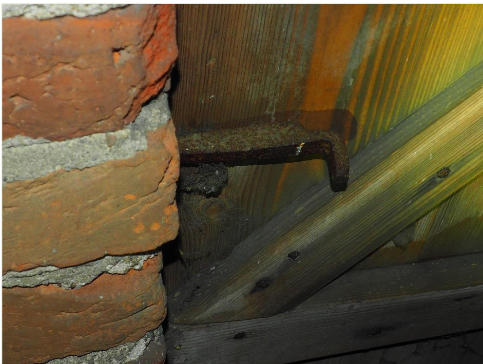
69. Wozławki, kościół parafialny p.w. Św. Antoniego Opata; wieża, elewacja północna, kondygnacja IV – okienca deskowo – szpungowa, rewers (wnętrze, piętro V - dzwonnica). Przykład i stan zachowania okuć mocujących (hak montażowy).
