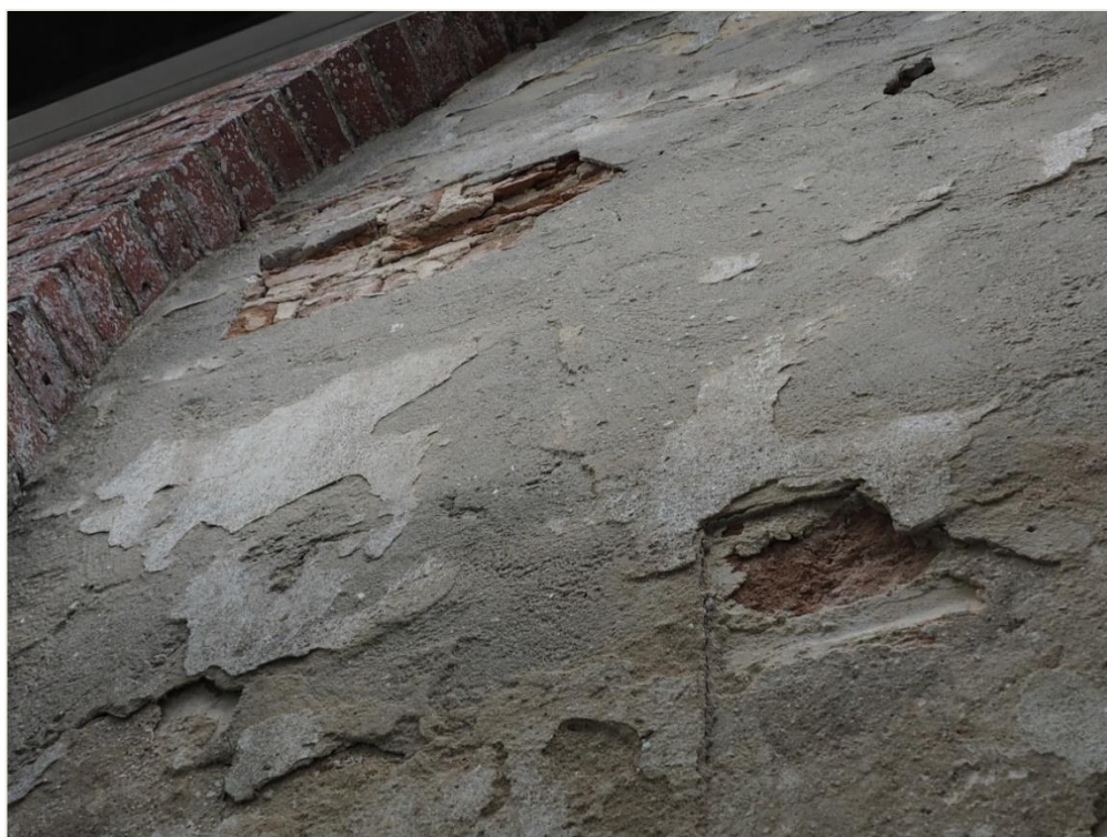
31. Wozławki, kościół parafialny p.w. Św. Antoniego Opata; zakrystia - elewacja północna; szczyt (zwieńczenie, część środkowa), fragment blendy. Odspojenia, głębokie uszkodzenia tynków cementowo – wapiennych i wapiennych; w obrębie ubytków osłabione strukturalnie tynki średniowieczne lub fragmenty podłoża konstrukcyjnego.
