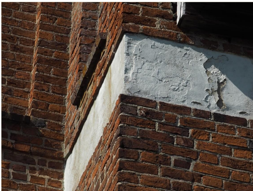
34. Wozławki, kościół parafialny p.w. Św. Antoniego Opata; korpus - elewacja południowa (zwieńczenie, strona północna); fragment fryzu pasowego. Odspojenia i głębokie ubytki wypraw tynkarskich; współczesne uzupełnienia i przemalowania.
