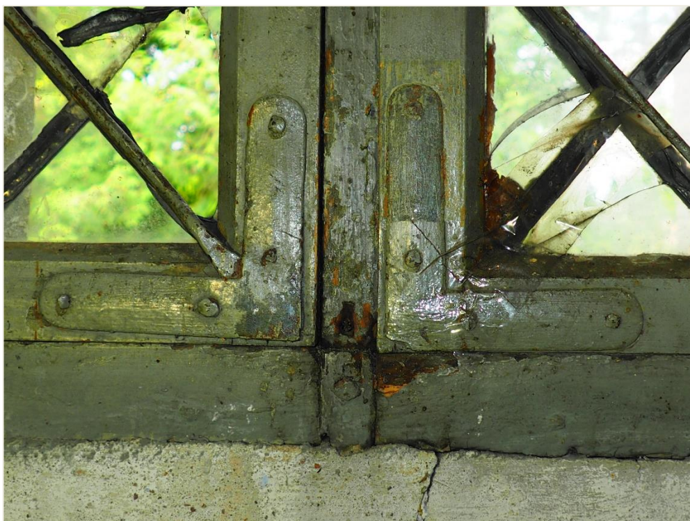
57. Wozławki, kościół parafialny p.w. Św. Antoniego Opata; zakrystia – okno, rewers (wnętrze zakrystii). Przykład i stan zachowania historycznych okuć łączących (narożniki).
