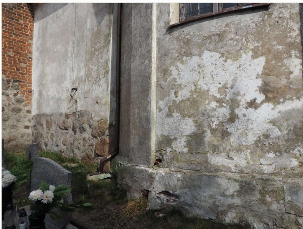
39. Wozławki, kościół parafialny p.w. Św. Antoniego Opata; kruchta południowa i rotunda/kaplica - elewacje, strona zachodnia (przyziemie). Wyraźne oznaki zawilgocenia murów; liczne współczesne uzupełnienia i przemalowania historycznych wypraw tynkarskich; spękania i głębokie ubytki cokołu.
