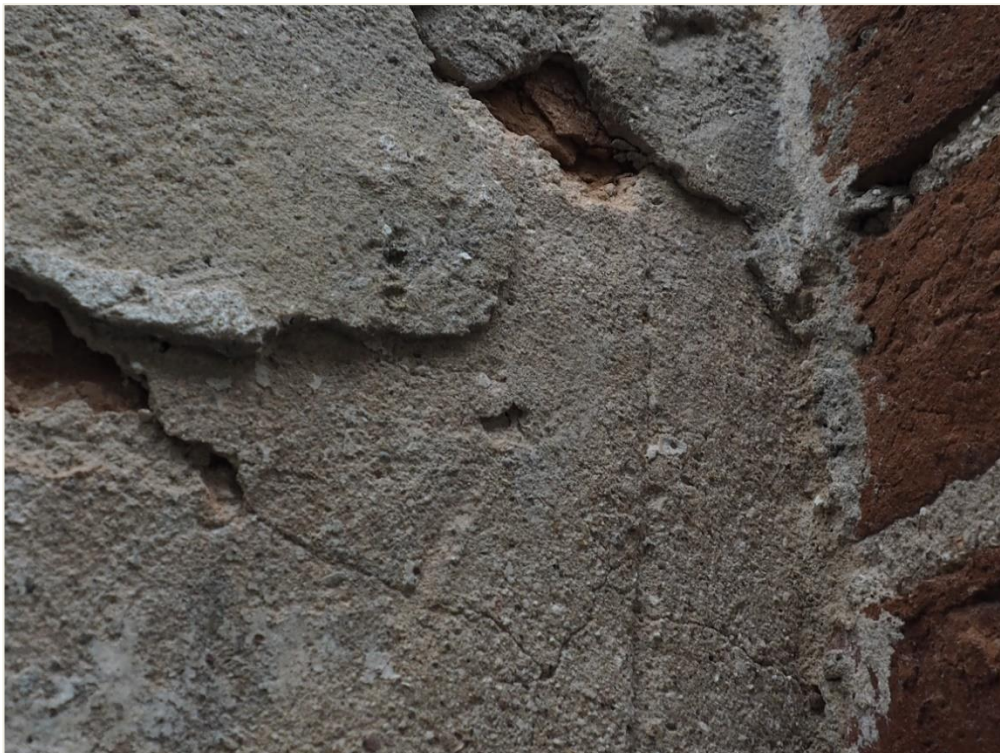
32. Wozławki, kościół parafialny p.w. Św. Antoniego Opata; zakrystia - elewacja północna; szczyt (zwieńczenie, część środkowa), fragment wnętrza blendy. Średniowieczny tynk wapienny i relikty rytów dekoracji maswerkowej; nieliczne szczątki późniejszych przemalowań, gruba warstwa tynku cementowo – wapiennego i wykończenie zacierką z zaprawy wapiennej.
