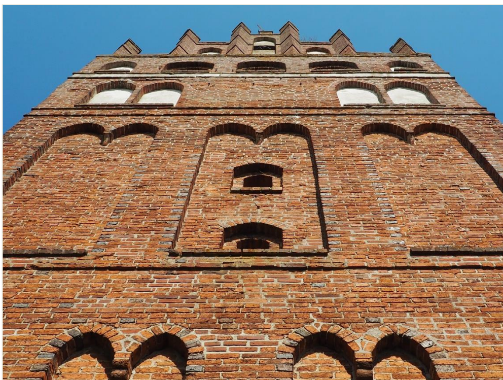
37. Wozławki, kościół parafialny p.w. Św. Antoniego Opata; wieża - elewacja zachodnia (kondygnacje II-IV). Ubytki zapraw średniowiecznych oraz historyczne uzupełnienia spoinowań wykonane zaprawą cementowo – wapienną; poniżej gzymsów i parapetów większe ubytki budulca oraz skupiska mikroorganizmów roślinnych.
