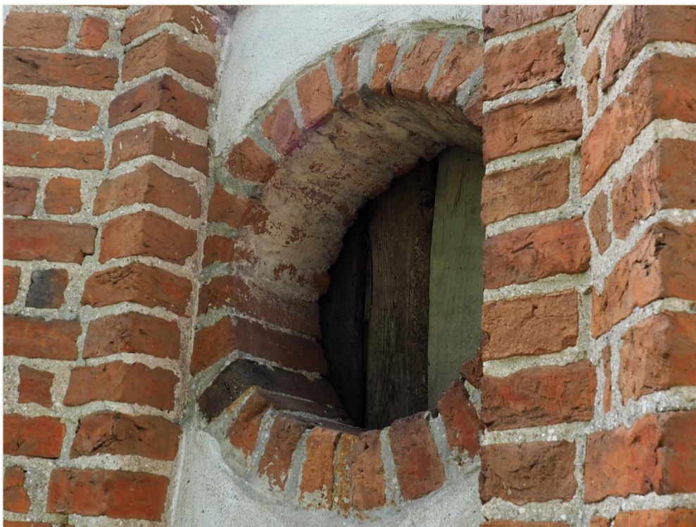
55. Wozławki, kościół parafialny p.w. Św. Antoniego Opata; korpus, elewacja wschodnia, szczyt (poziom I, strona południowa) – okno, awers (zaślepienie przeźrocza prowizorycznym skrzydłem z desek).
