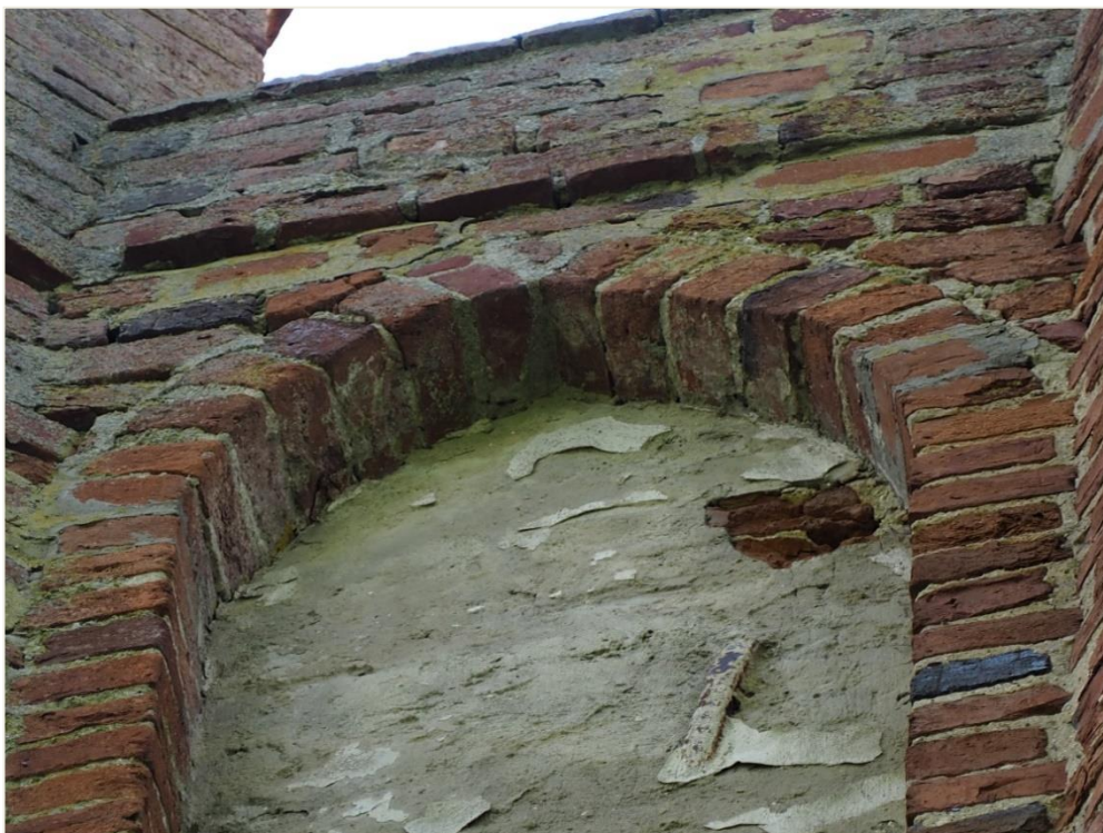
12. Wozławki, kościół parafialny p.w. Św. Antoniego Opata; korpus - elewacja wschodnia; fragment szczytu (poziom III, strona południowa). Silne zawilgocenie elementów wieńczących; głębokie ubytki zapraw i rozluźnienie struktury murowej stopni i współczesne naprawy wykonane zaprawą cementową.
