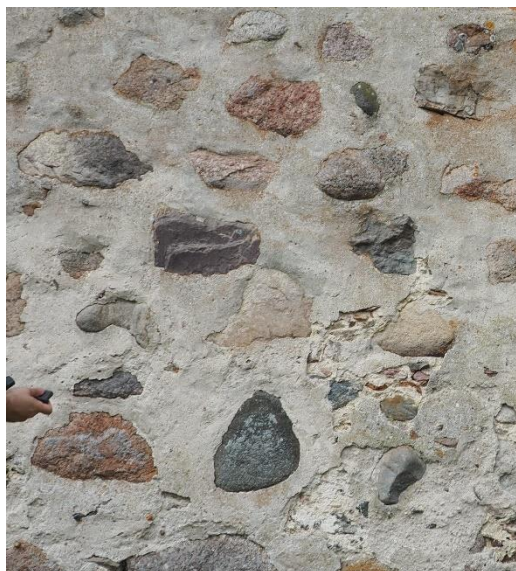
Obecny stan lica muru kamiennego.
