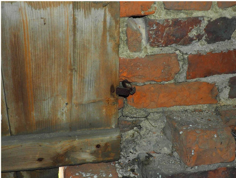
68. Wozławki, kościół parafialny p.w. Św. Antoniego Opata; wieża, elewacja północna, kondygnacja IV – okienca deskowo – szpungowa, rewers (wnętrze, piętro V - dzwonnica). Przykład i stan zachowania okuć mocujących (hak montażowy).
